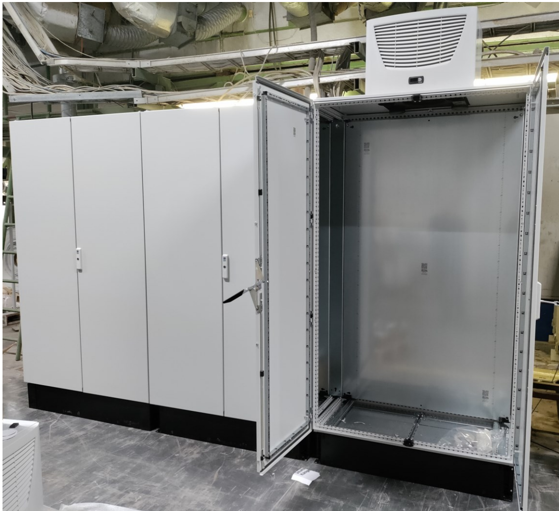
Figur 42. Kontrollskåp från Rittal med kylaggregat.
