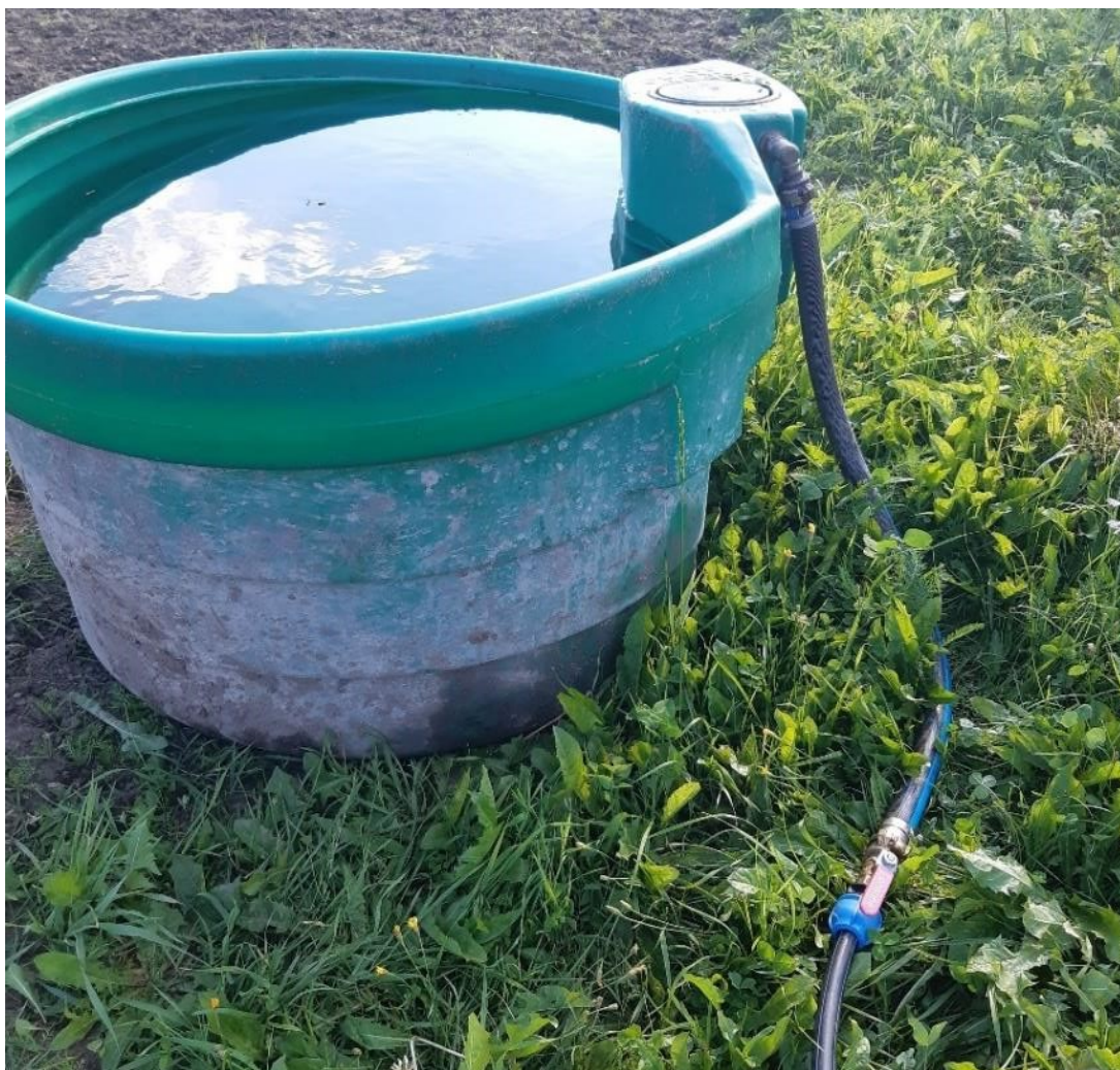
KUVA 21. Juottoallas Tila B:n painevesiverkostossa, lisäksi maassa näkyvissä kyseisen juottoasteen oma sulkuhana (Huttunen 2022n).
