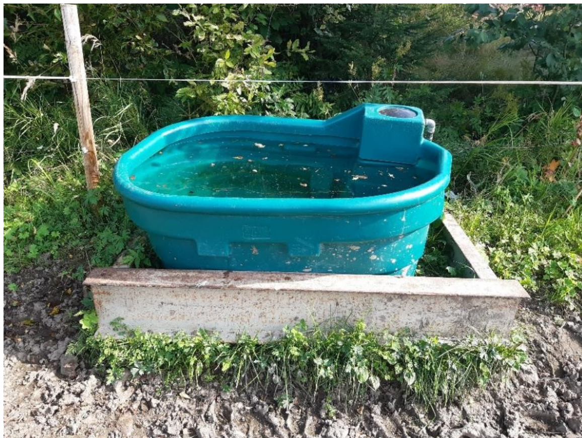
KUVA 24. Tilan painevesijohtoon kuuluva allas sisäänrakennetulla uimurilla ja tilallisten omavalmisteinen, rautainen tukikehikko, joka suojaa allasta eläinten aiheuttamalta paineelta (Huttunen 2022p).
