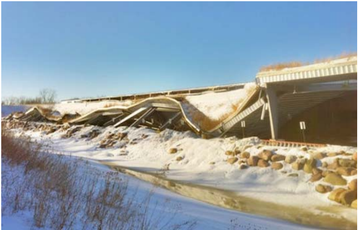
Kuva 85. Aquascape Inc. romahtanut katto.
