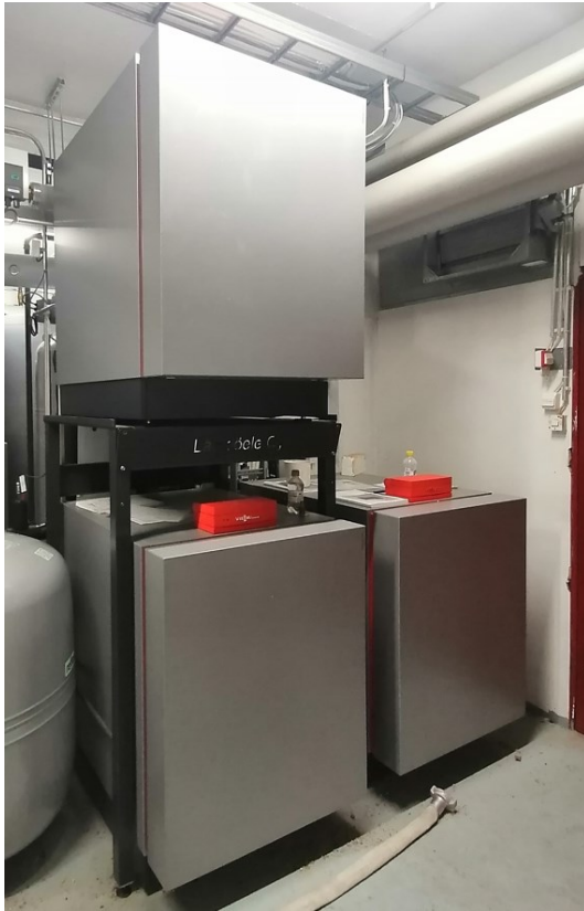
Kuva 31. Muurlan koulun maalämpöpumppu.
