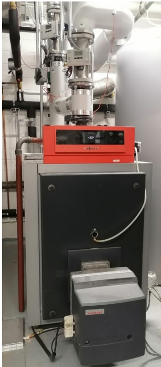
Kuva 32. Muurlan koulun kondenssiöljykattila ja poltin.
