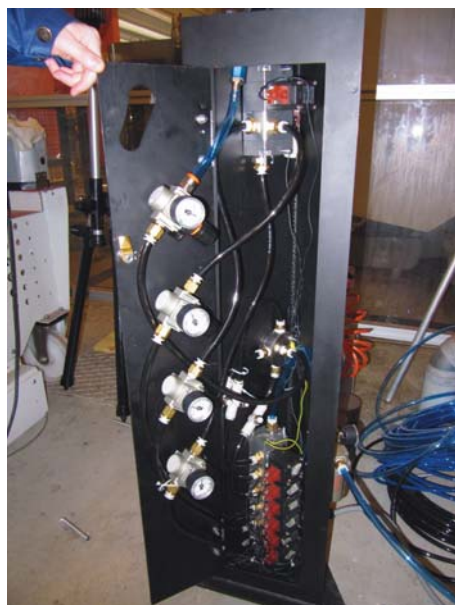
KUVA 11. Paineilmakomponentit tornin sisällä.
