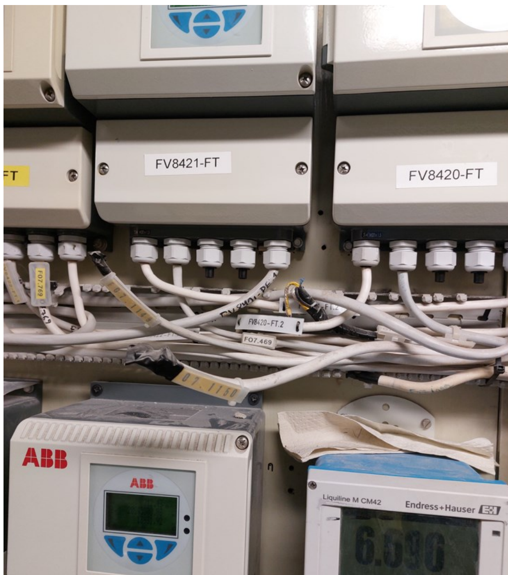
KUVA 19. Purkamattomia instrumentointikaapeleita FRK5 ristikytkentätilassa (Tissari, Tuomas 2023)
