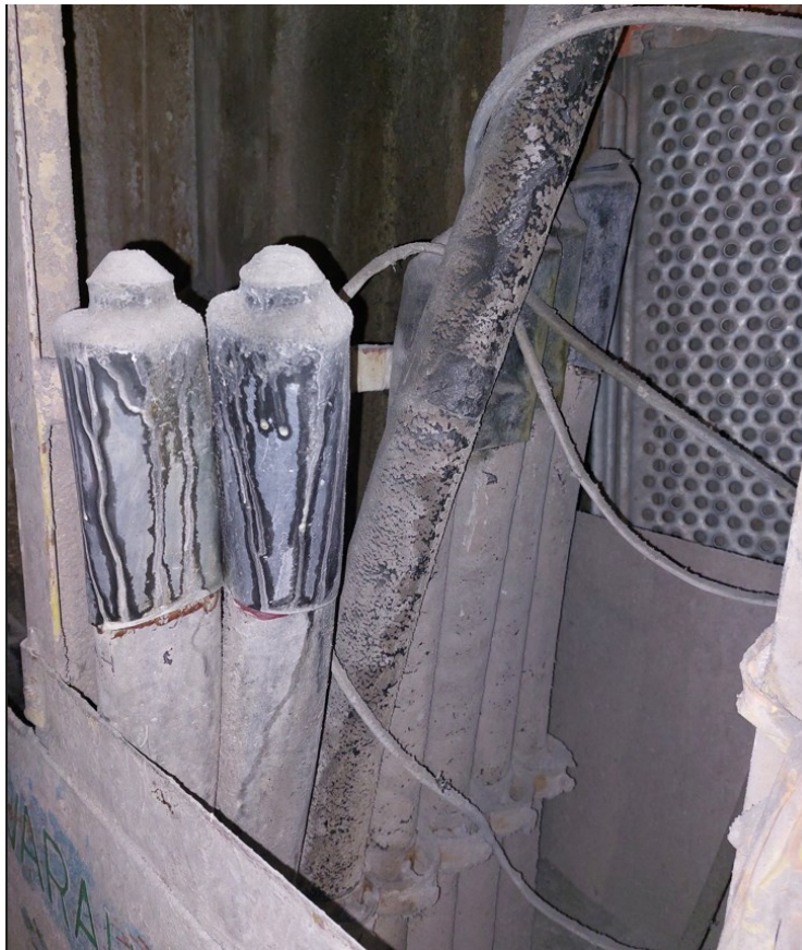
KUVA 8. Käytöstä poistettuja 10 kV kaapeleita (Tissari, Tuomas 2023)
