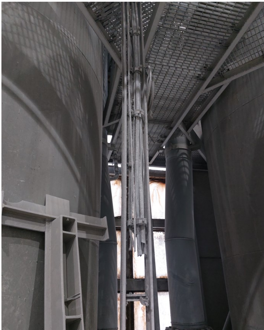
KUVA 20. Purkamattomia kaapeleita väkevöintilaitoksella (Tissari, Tuomas 2023)
