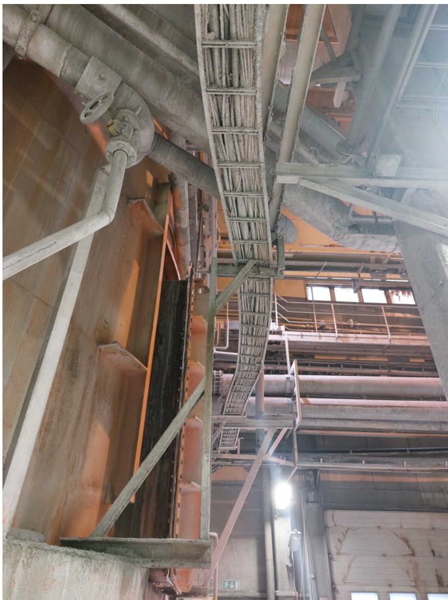
KUVA 13. Uusittava kaapelihylly FV258 säiliön trukkiluukun edessä (Tissari, Tuomas 2023)
