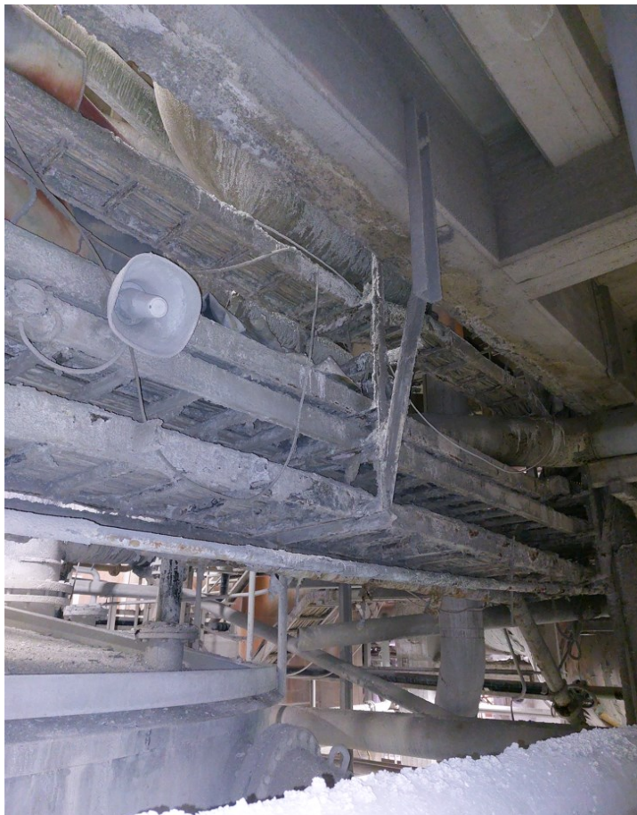
KUVA 15. Uusittava kaapelihylly FH285 säiliön yläpuolella (Tissari, Tuomas 2023)
