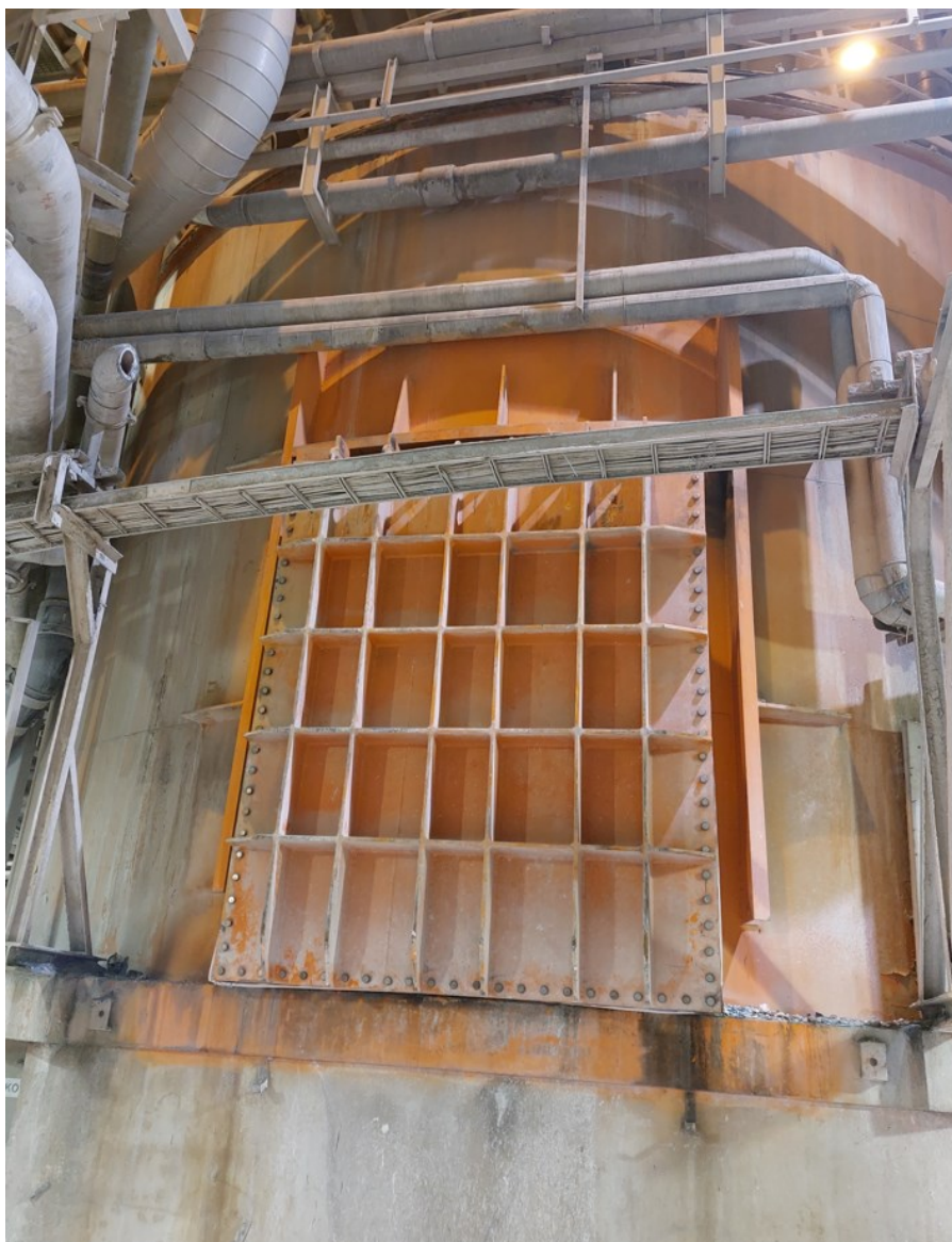
KUVA 14. Uusittava kaapelihylly FV258 säiliöllä (Tissari, Tuomas 2023)
