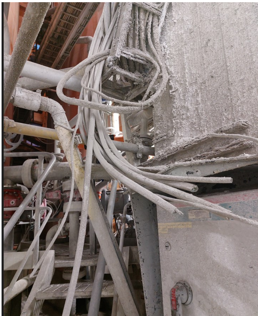
KUVA 18. Purkamattomia instrumentointikaapeleita FVL3 alakerrassa (Tissari, Tuomas 2023)
