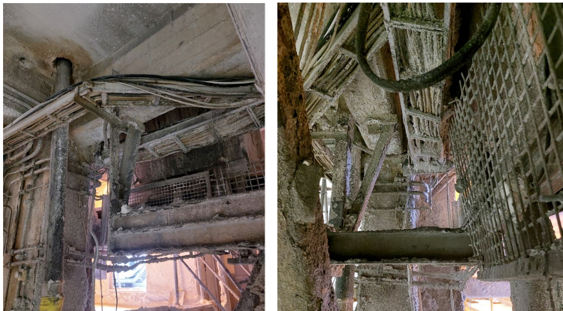
KUVA 16. Uusittava kaapelihylly FS460 suotimen alapuolella (Tissari, Tuomas 2023)
