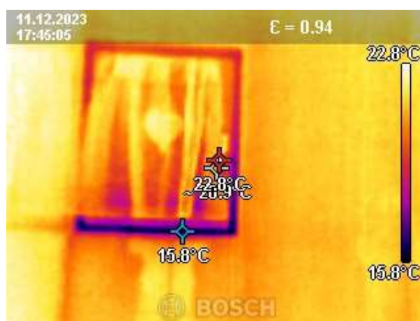
Kuva 20. Erillisen wc:n ikkunan lämpökamerakuva
