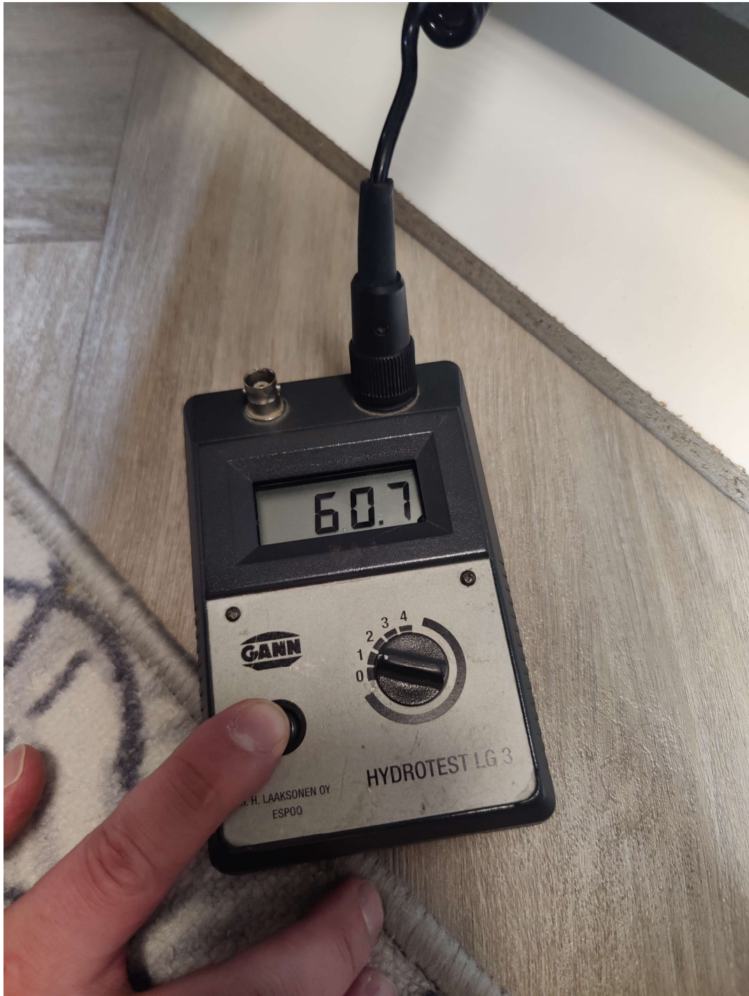
Kuva 33. Pintakosteus keittiön alasokkelin alapuolella
