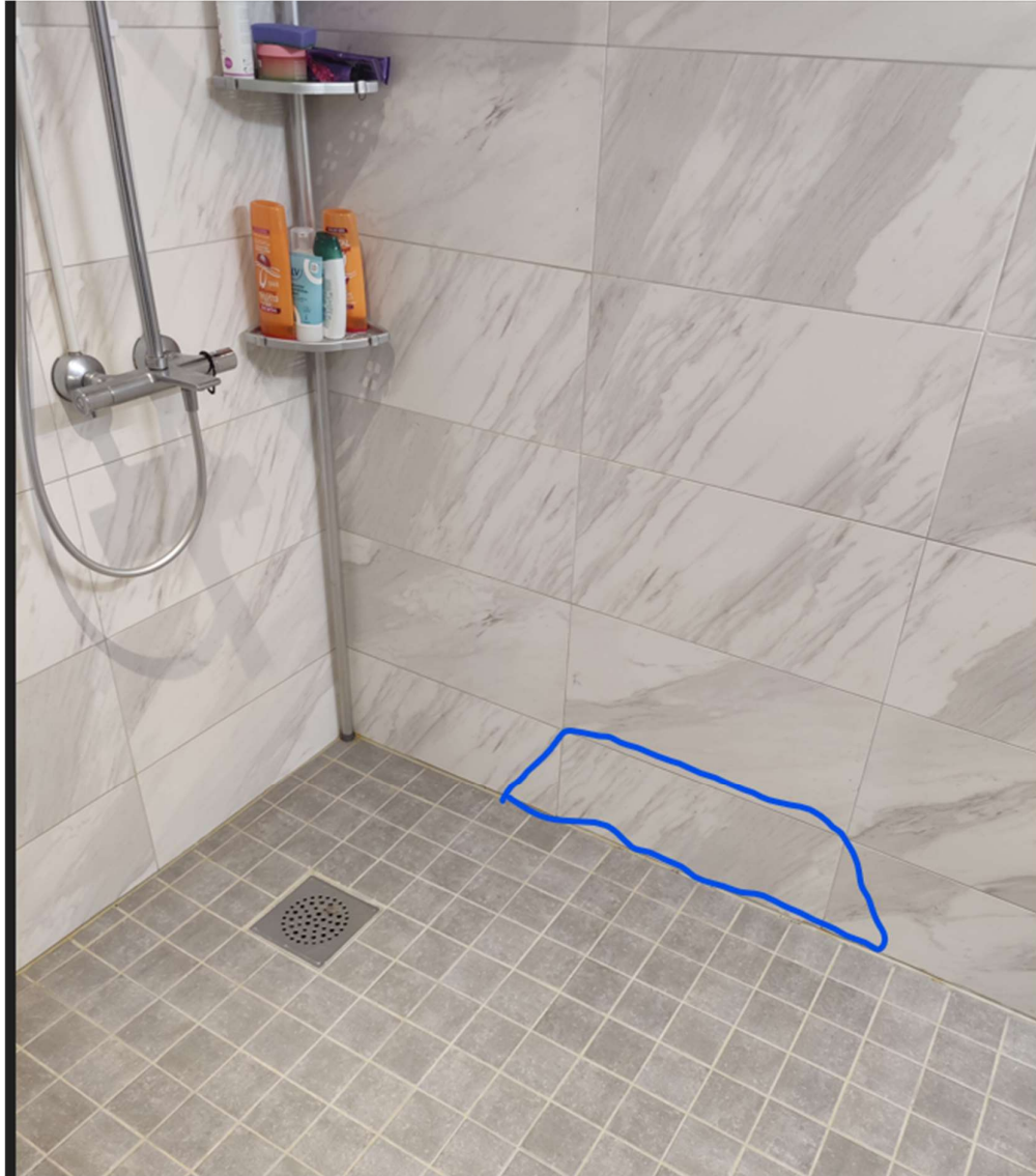
Kuva 31. Seinän kohdalle merkitty kohonneita pintakosteusarvoja
