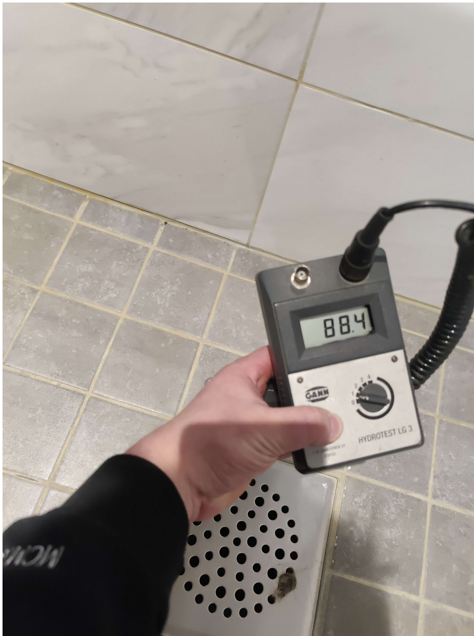
Kuva 27. Kaivon ympärillä pintakosteusarvo
