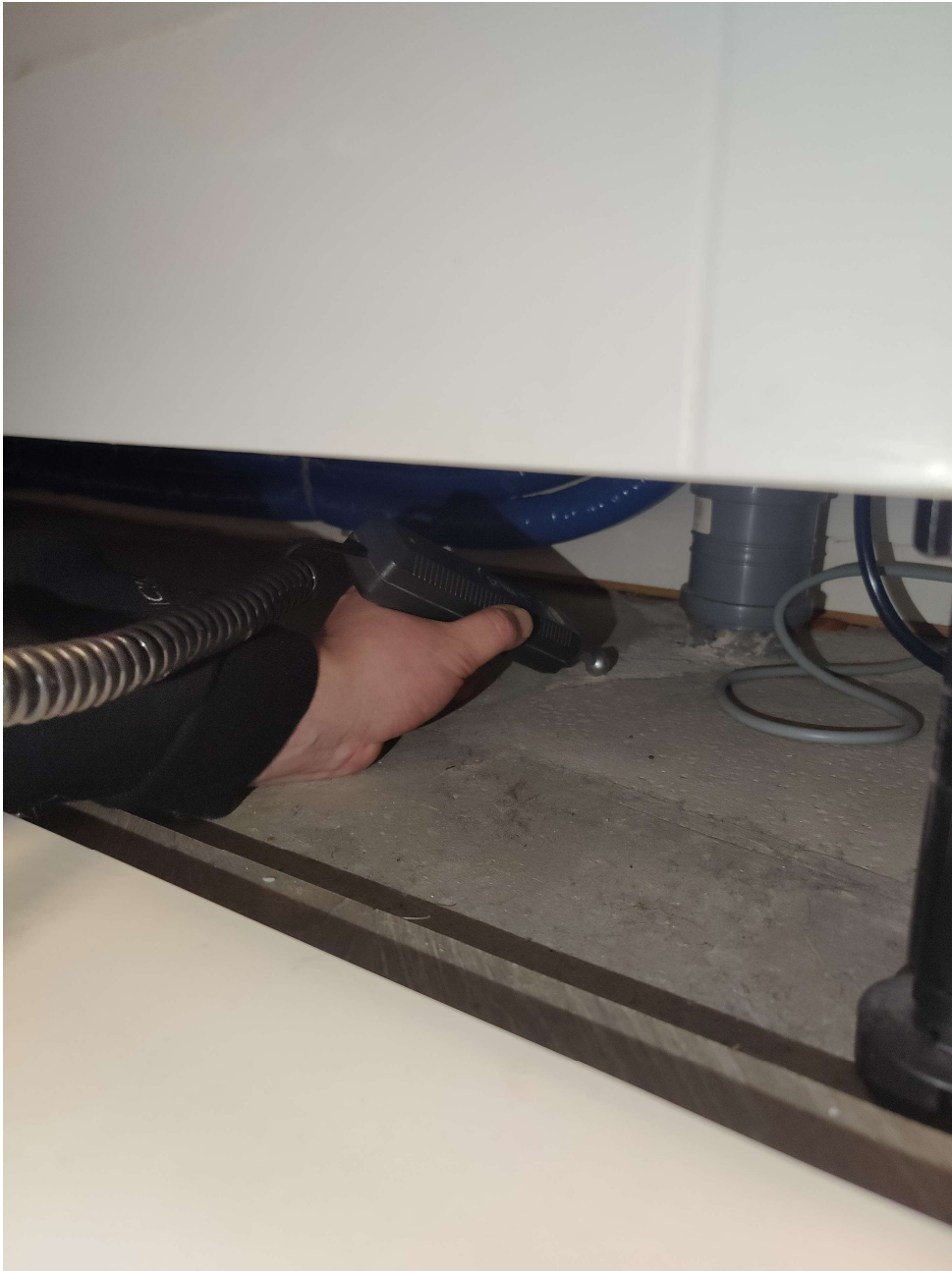
Kuva 32.Keittiön pintakosteusmittaus viemärin läheisyydessä
