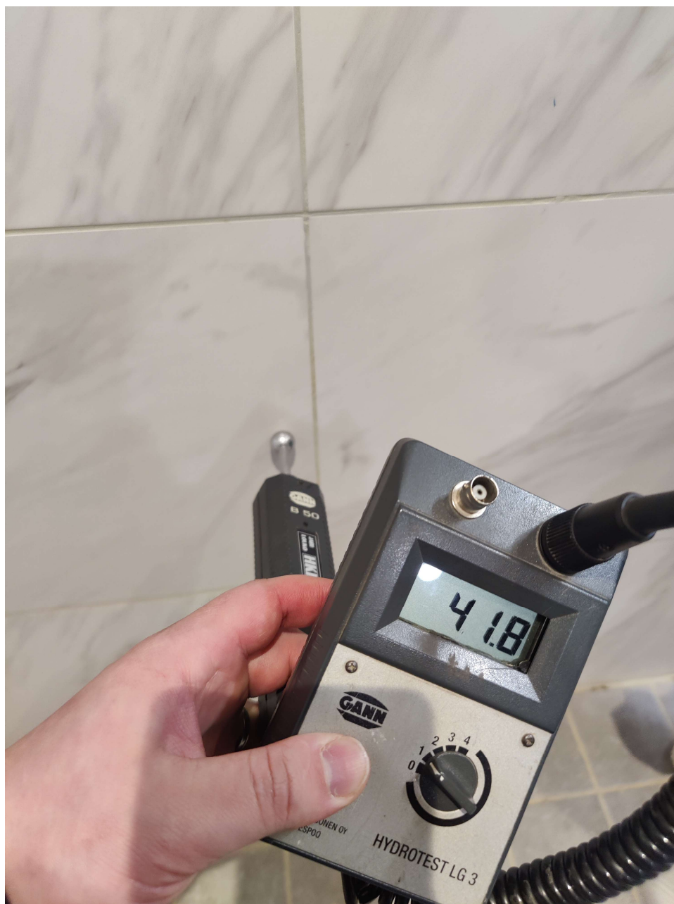
Kuva 29. Pintakosteusarvo seinältä noin 50 cm korkeudella suihkun rasitusalueella
