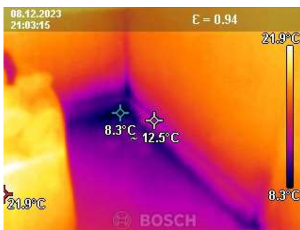
Kuva 22. Lämpökamerakuva vaatekaapin nurkasta makuuhuoneesta
