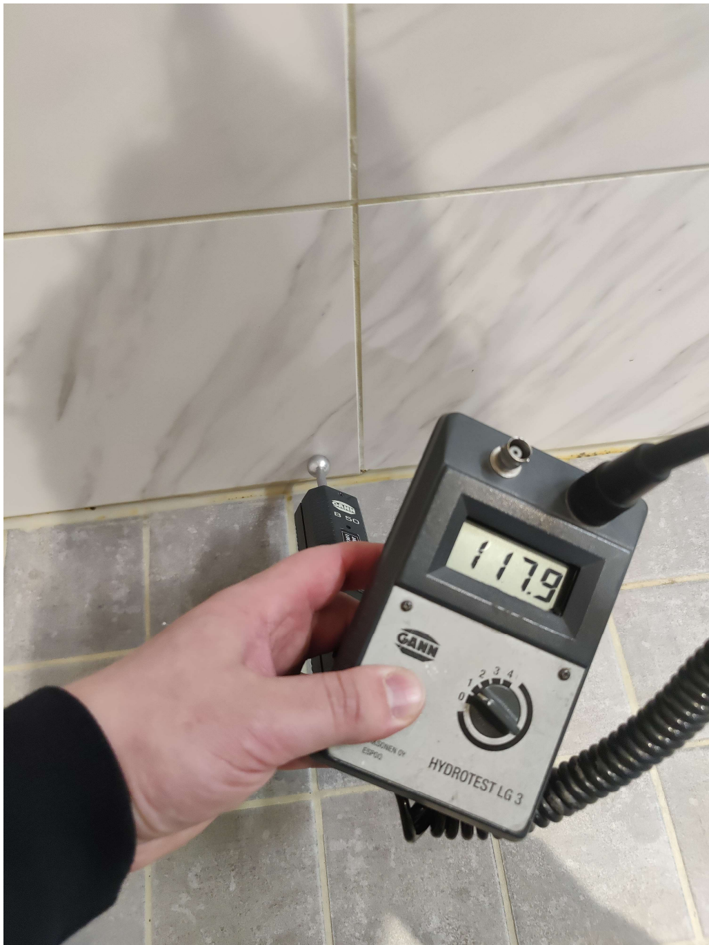
Kuva 30. Kohonneita pintakosteusarvoja seinän alimmalla laamalla
