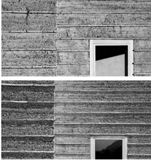
Kuva 3. Itävallan Schlinsissä sijaitseva Rauchin talo ylempänä vasta valmistuttuaan ja alempana kaksi vuotta valmistumisen jälkeen. Kuva: Sauer, M. & Kap-finger, O.
