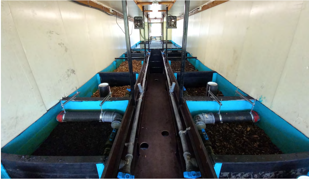
Kuva 4. Kuvassa vasemmalla linjan 2 ja oikealla linjan 1 altaat täytettyinä suodatinmateriaaleilla (kuva Salla Pulliainen).
