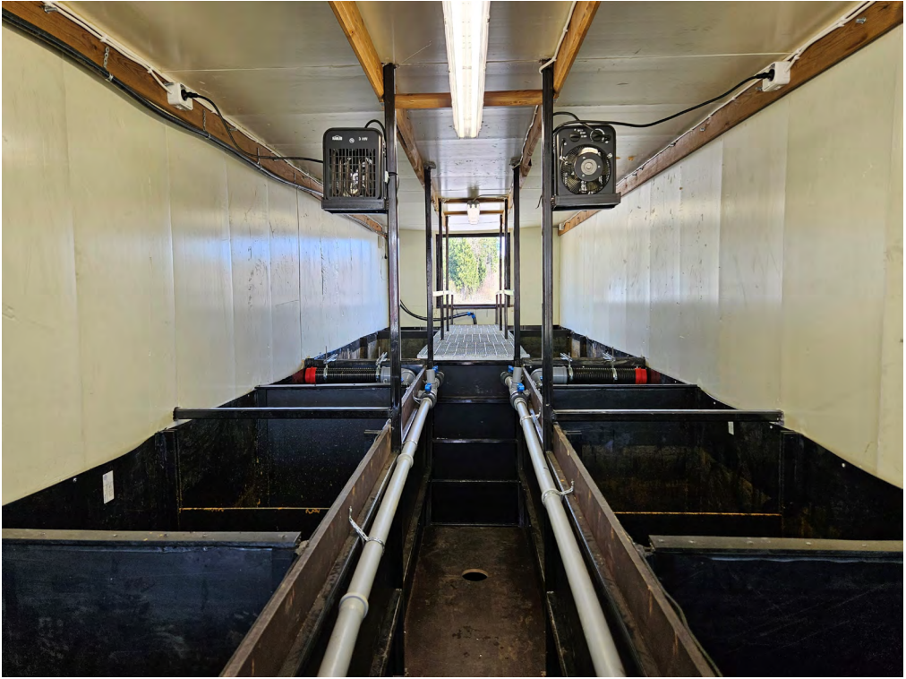
Kuva 5. Taka-alalla kuvassa demonstraatioympäristön esikäsitteilyallas, josta vesi johdetaan kuvan etualalla näkyville linjastoille (kuva Salla Pulliainen).
