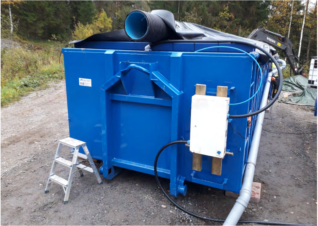
Kuva 3. Virtaamansäätöventtiili sijaitsee lavan kylkeen asennetussa kaapissa (kuva Aki Mykkänen).
