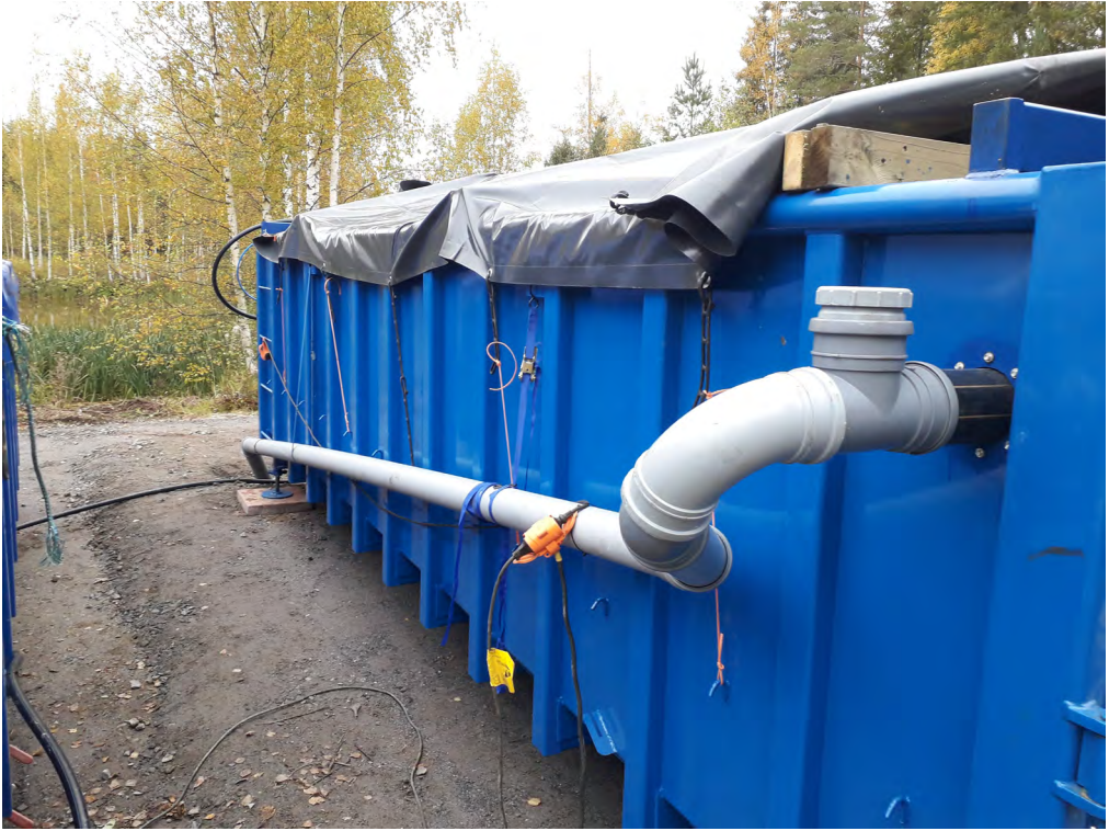
Kuva 1. Raudanpoistoyksikön poistoputki johtaa tasausaltaaseen. Poistoputkessa on yhde näytteenottoa varten (kuva Aki Mykkänen).
