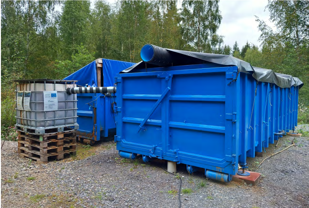
Kuva 6. Käsiteltävä vesi johdetaan kuvassa oikealla olevasta raudanpoistoyksiköstä kuvassa vasemmalla olevan IBC-kontin läpi takana näkyvään bioreaktoriin (kuva Salla Pulliainen).
