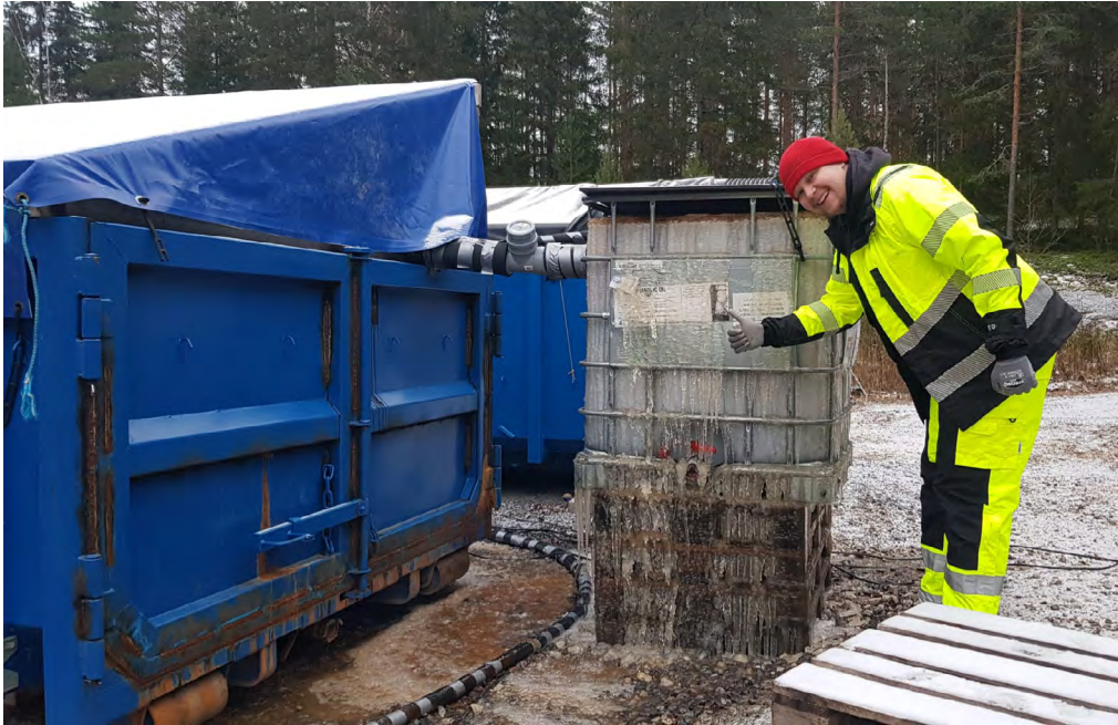
Kuva 3. Veden jäätyminen aiheuttaa putkiston tukkeutumisen ja siten ylitulvimisriskin (kuva Salla Pulliainen).
