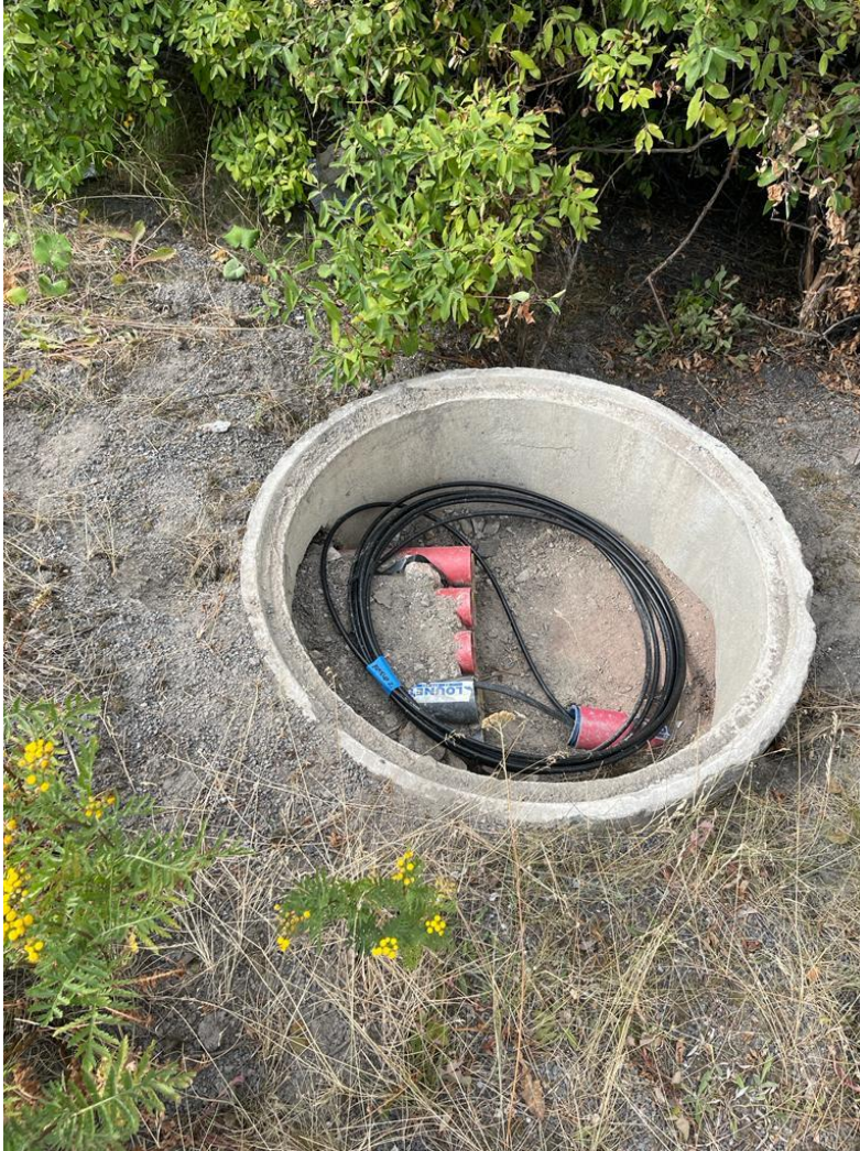
Kuva 11. Kaapelikaivo (kuva A. Perälä)
