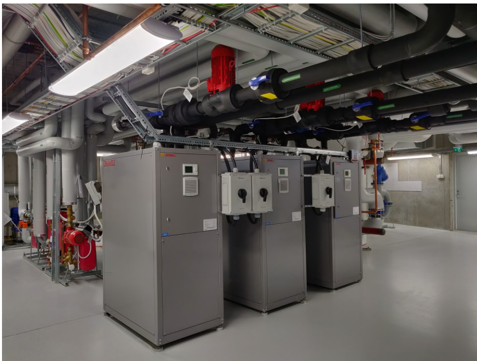
Kuva 1. Metropolian Myllypuron kampuksen lämmönjakohuone.
