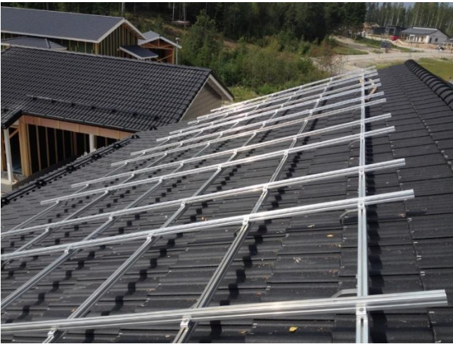
Kuvio 5. 2-kerrostelineessä on kahdessa tasossa alumiiniprofiilit. Tähän telineeseen aurinkopaneelit tulevat vaakaan lappeen suuntaisesti. (Kiinnitysteline. N.d)
