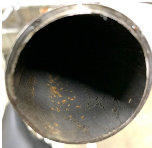
Kuvio 28. Kuva elintarvikelaitoksessa suorahöyryprosessiin johtaneesta höyryputkesta
