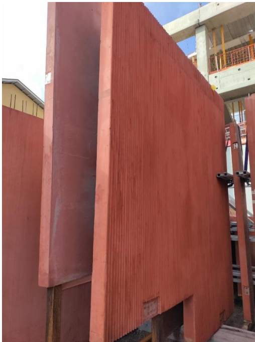
Kuva 1. Julkisivuelementin yläreunassa näkyy muotin raja. (Kuva: Säde Viljanen 2023)
