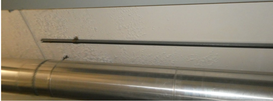
Kuva 40. Maalattun betonin pintaan syntyneitä vesipusseja.
