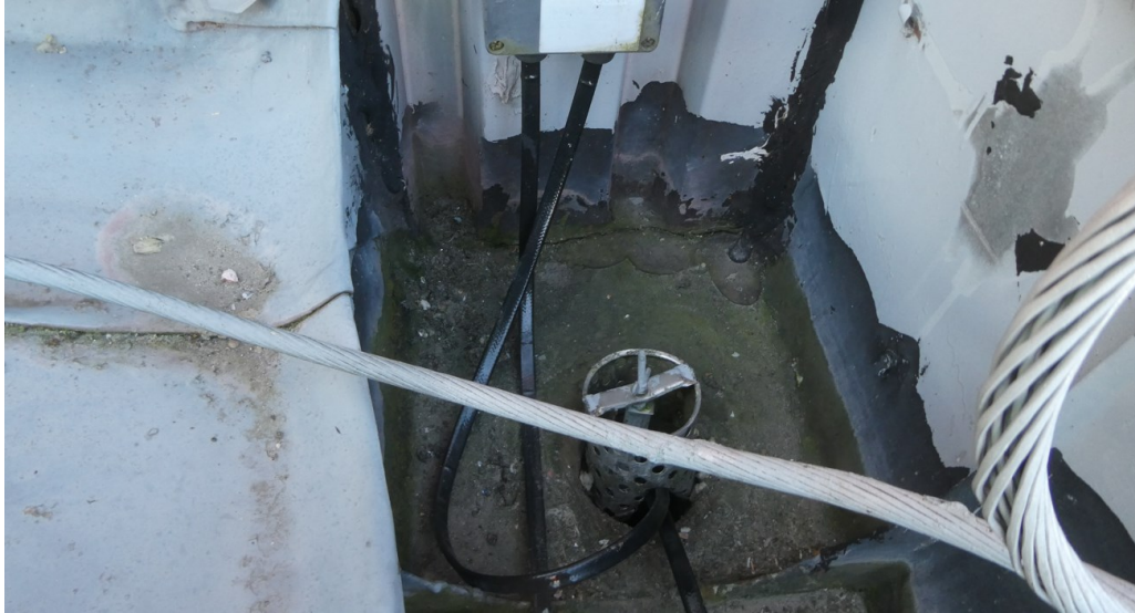
Kuva 30. Vesikourun pää on toteutettu virheellisesti julkisivupeltiä vasten.
