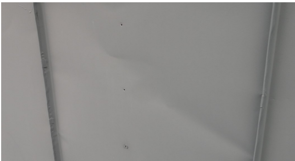
Kuva 23. Tiivistämättömiä reikiä pellityksissä.
