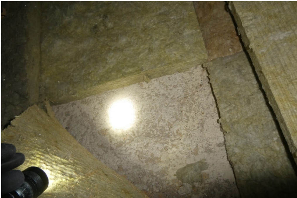
Kuva 36. Alkuperäinen yläpohjan eristys, ei erillistä höyrynsulkukerrosta.
