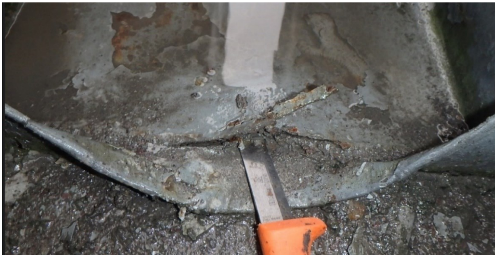
Kuva 29. Vesikourun pohjassa puhki ruostunut sauma.
