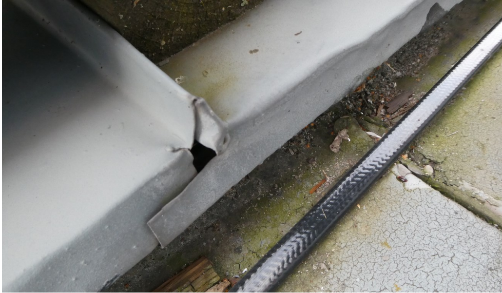
Kuva 21. Saumassa heikkoa työn laatua ja taittamaton pystysauma.
