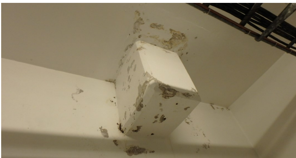
Kuva 39. Kattovuodosta vaurioitunut kotelo.
