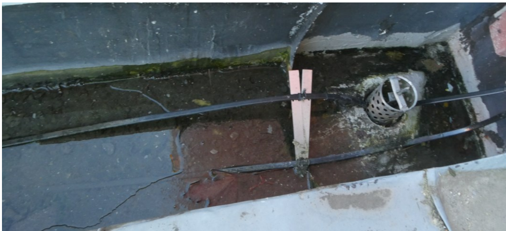
Kuva 31. Kaivo on kourun pohjaa ylempänä.
