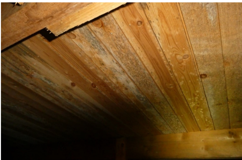
Kuva 35. Vaurioita puurakenteessa heikon tuuletuksen vuoksi.
