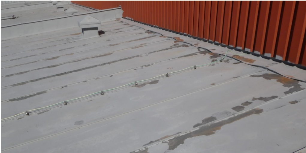
Kuva 20. OL1 D-rakennuksen katolla maalaus on laajasti irronnut.
