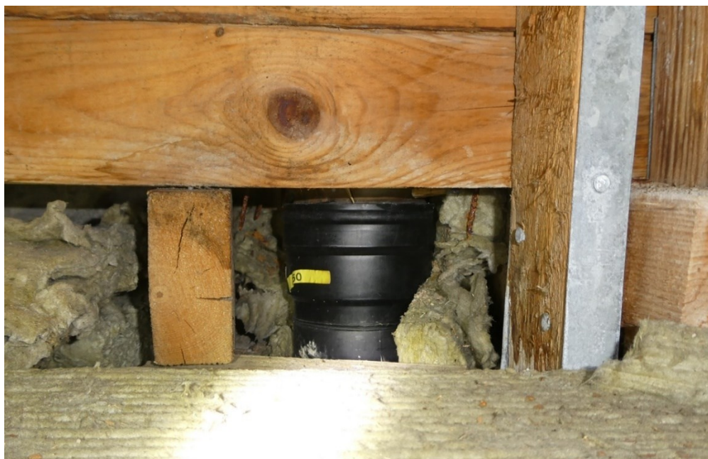
Kuva 37. Sadevesiputken eristys on puutteellinen.
