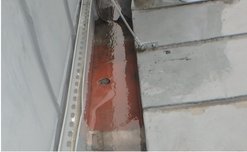
Kuva 28. Virheellisesti pellitetty kaivon ympäryys.
