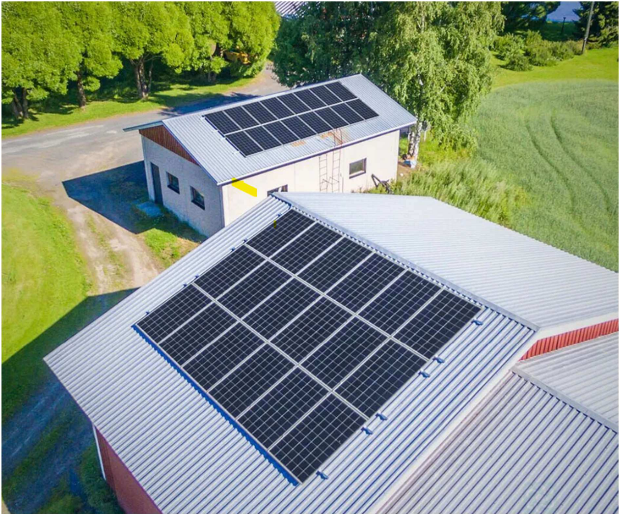
Kuva 23 Katolle asennettu aurinkosähköjärjestelmä. (Väre, n.d.).
