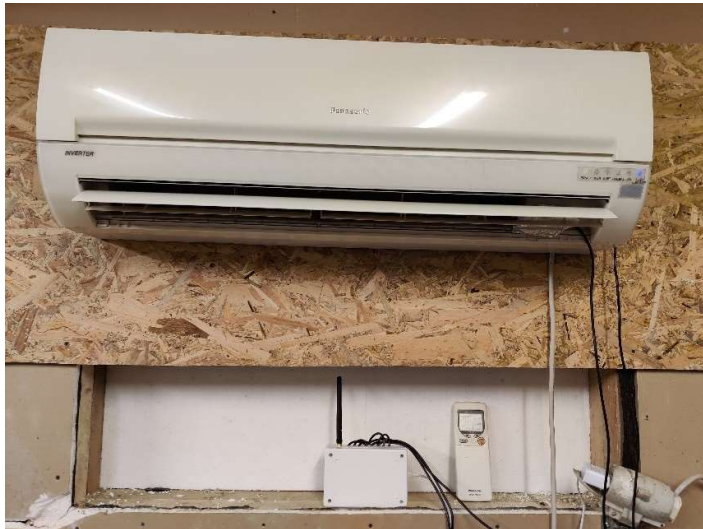
Kuva 19. Koelaitteiston kokoonpano sisällä
