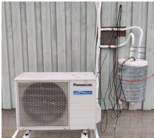
Kuva 18. Koelaitteiston kokoonpano ulkona
