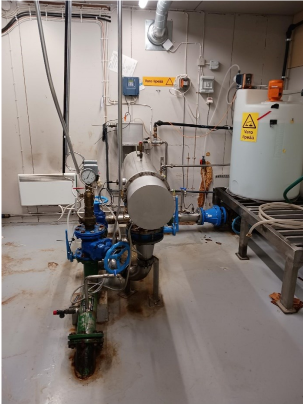
Kuva 4. Vedenottamon laitoksen prosessitilat.
