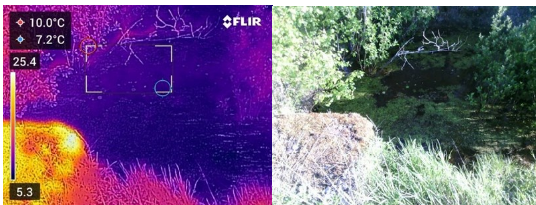
Kuva 22. Havaintopiste 7. Oja padottui salaojien tasoon, mikä puoltaa sitä, että vettä tulee ojaan lisää jatkuvasti.
