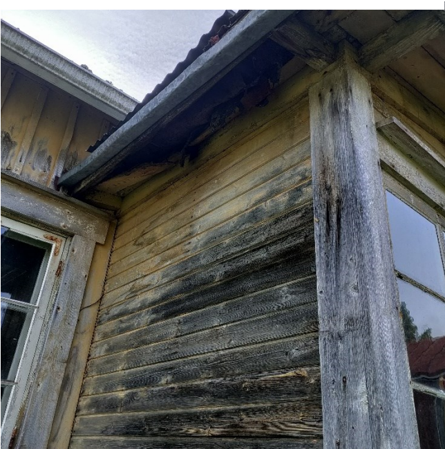
Kuva 10. Kosteus- ja lahovaurio ulkona
