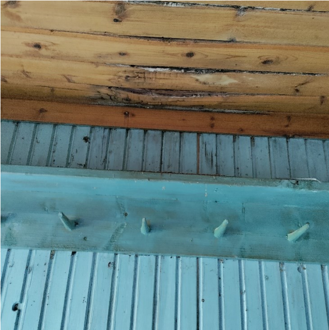
Kuva 9. Kosteus- ja lahovaurio sisällä.
