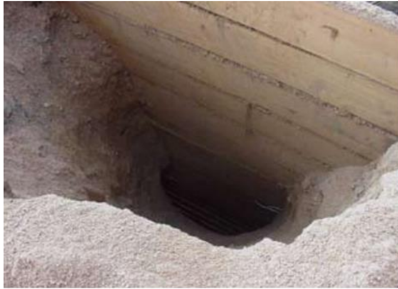
Kuva 5. Esimerkki maamassan holvaantumisesta settiseinän takana (Perko 2008, 53).
