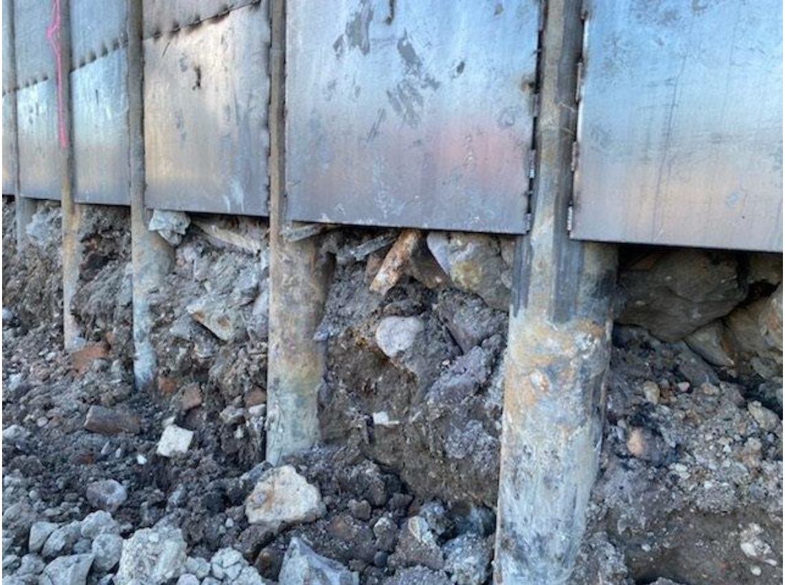
Kuva 16. Lohkareita, jotka on ohitettu poropaalujen ja teräslevyjen avulla.
