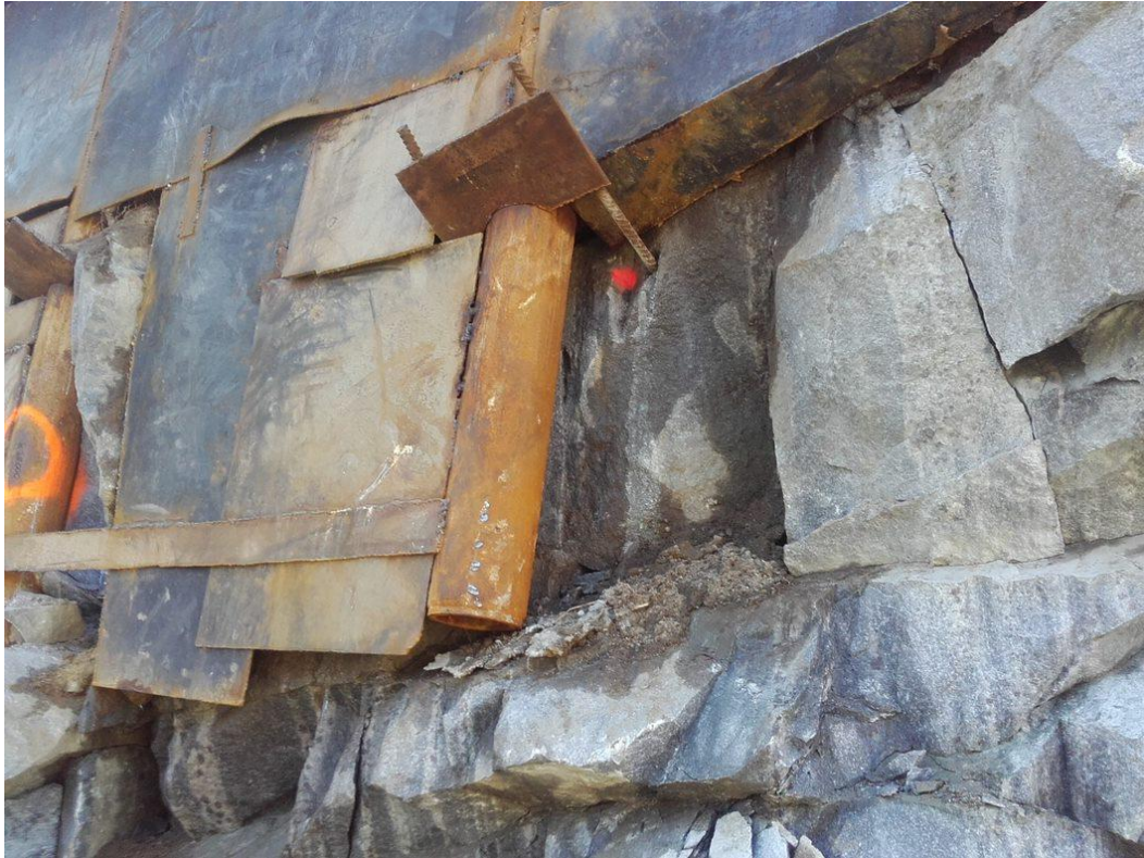
Kuva 19. Porapaalu ei ole tarttunut kallioon, jonka vuoksi se on jouduttu pulttaamaan kallioon kiinni.
