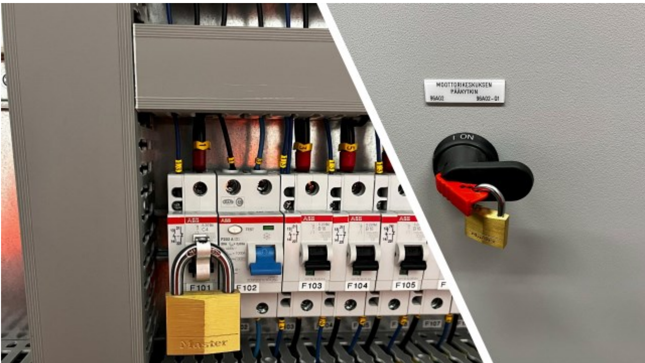
Kuva 3. Esimerkki sähkökeskuksen lukituksista
