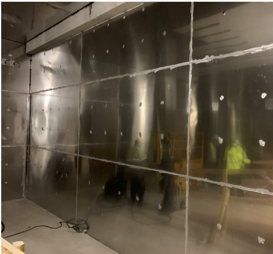
Kuva 5. Sähkötilan pinnat päällystetty alumiinilevyillä [7].
