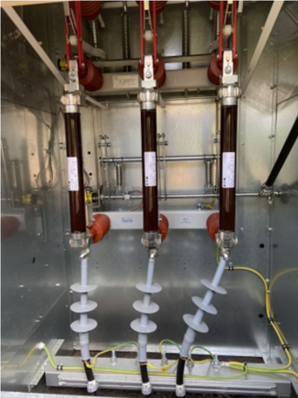
KUVA 5. Muuntajaerotin ja KJ-sulakkeet
