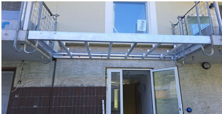
Kuva 4. Täydentävä kantava sisäänkäyntikatoksen teräsrunko. Rakenne ja pintakäsittelyt optimoitu, alkuperäisessä rakennesuunnitelmassa vain maininta teräskatoksesta.
