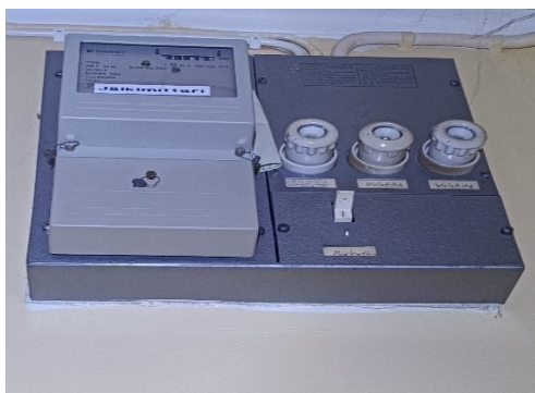
Kuva 6. Lujalevy sähkökeskuksen takana.
