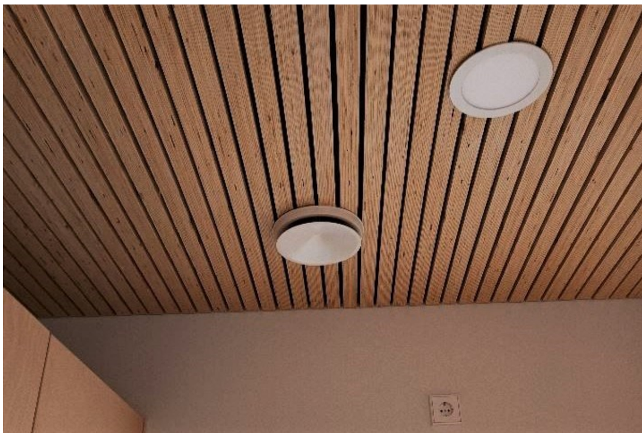
KUVA 3. Moottoripellillä varustettu korvausilmakanava toimii myös nykyrakentamisessa korvausilman toteutuksessa (kuva: Timo Marin).
