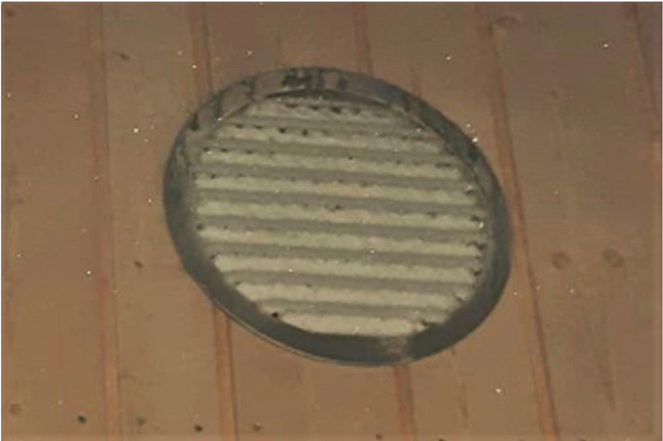
KUVA 4. Ulkoilman olosuhdemuutokset voivat vaikuttaa raitisilmasäleikön painehäviöön (kuva: Timo Marin).
