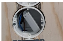
Kuva 46. Vuorokausiajastin asennettuna kojerasiaan.
