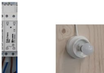
Kuva 45. Ryhmäkeskuksella oleva releyksikkö ja Ensto AVR6-valaisin.
