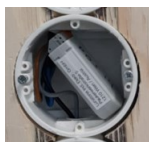
Kuva 50. Viikkopohjainen ajastin asennettuna kojerasiaan.
