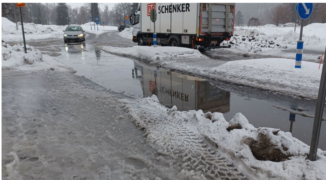
Kuva 8. Sulamisveden aiheuttama lätäkkö ajoradalla (Kuva: Tanja Pakkanen)
