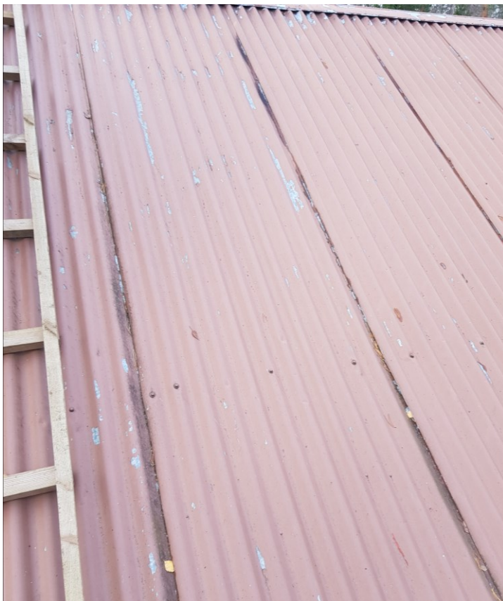
KUVA 26. Maalipinnassa kulumaa vanhanosan kattopellissä
