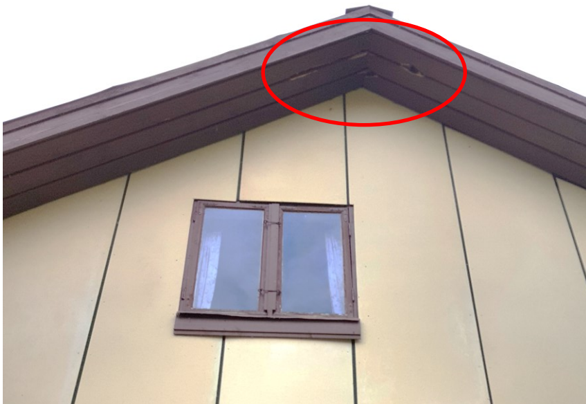
KUVA 11. Tikan tekemät reiät länsipuolen räystääslaudoituksessa merkitty punaisella
