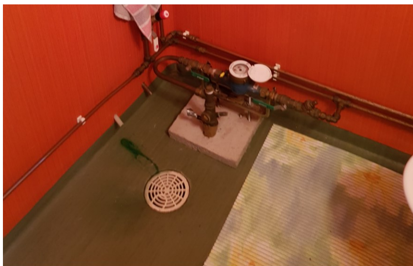
KUVA 43. Värjäymä WC:n lattiassa
