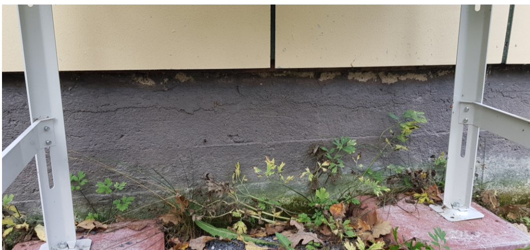
KUVA 13. Pakkasrapautumaa sokkelin yläreunassa ja rikkakasveja sokkelin alareunassa
