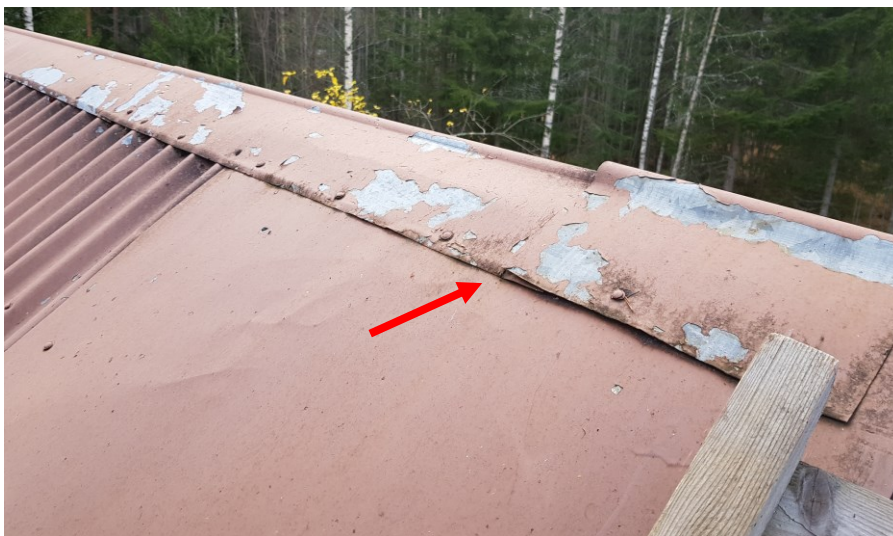
KUVA 28. Pellistä lähtenyt maalia vanhanosan katon harjalla
