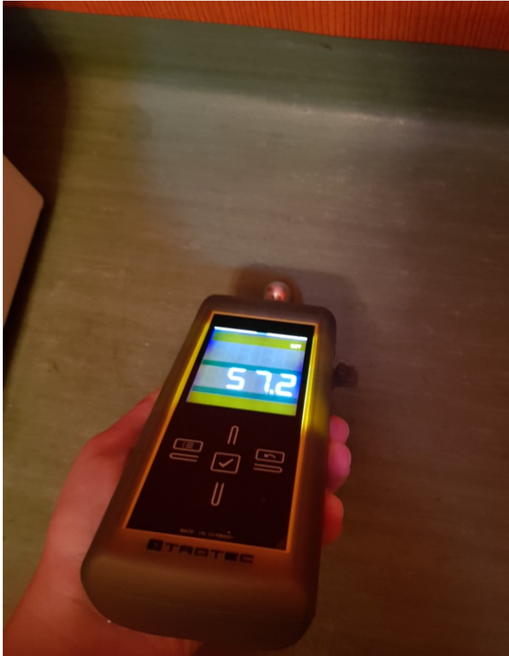
KUVA 41. Kuva pintakosteusmittauksesta WC:n lattiasta, mittauksen arvo Trotec T660 laitteella 57,2 yksikköä
