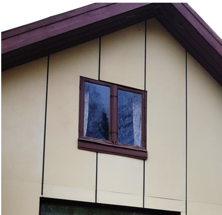
KUVA 36. Maali hilseillyt ullakon ikkunan puitteista
