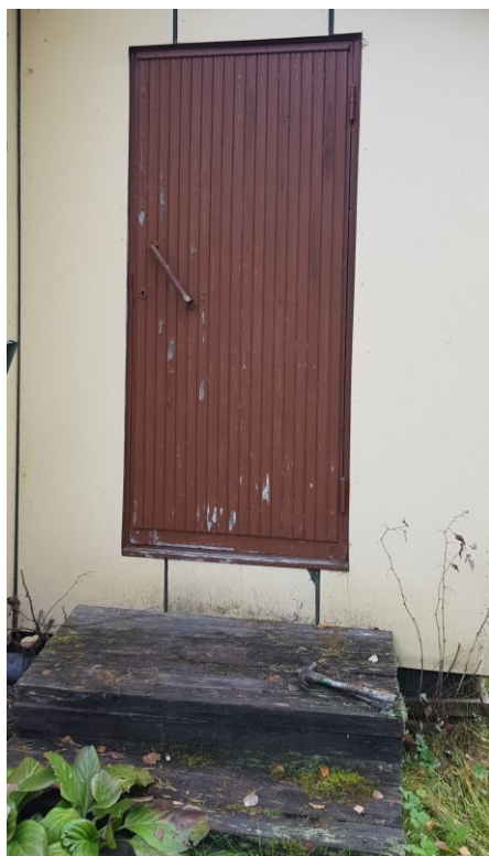
KUVA 31. Kylmävaraston ulko-ovi, josta on maali hilseillyt
