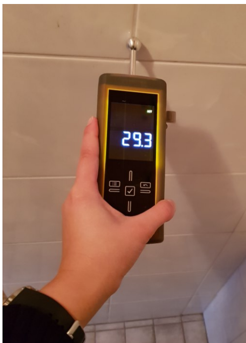
KUVA 39. Kuva pintakosteusmittauksesta kylpyhuoneen seinästä mittauksen arvo Trotec T660 laitteella 29,3 yksikköä
