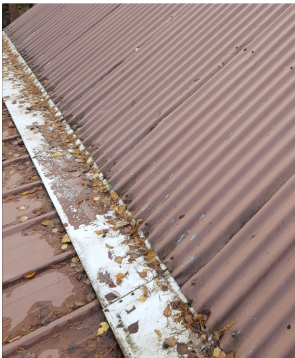
KUVA 27. Lehtiä vanhan- ja laajennusosan kattojen liitoskohdassa
