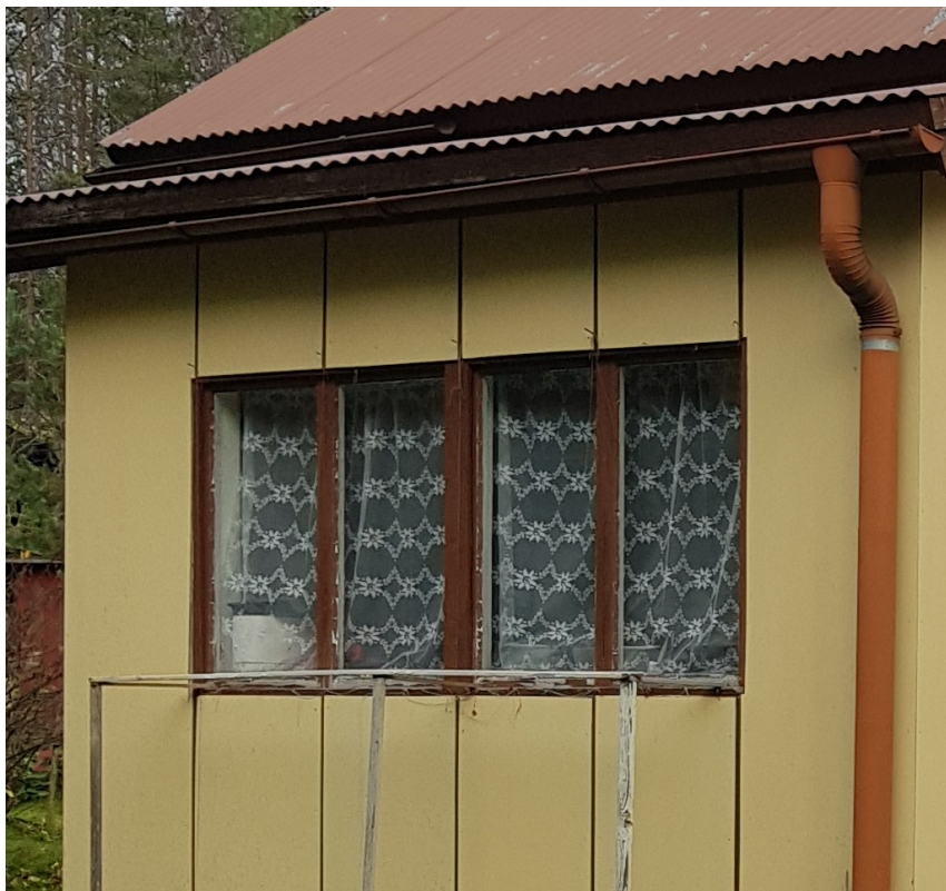
KUVA 35. Maali hilseillyt varastokäytössä olevan vanhan kuistin ikkunan puitteista
