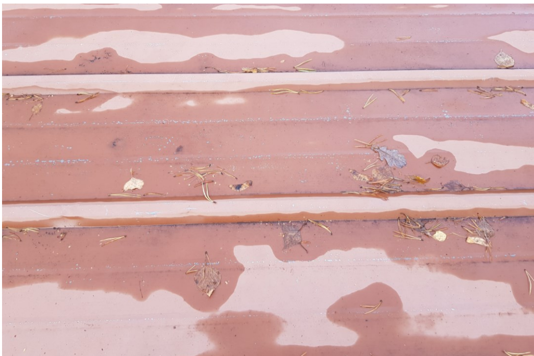
KUVA 25. Maalipinnassa kulumaa laajennusosan kattopellissä
