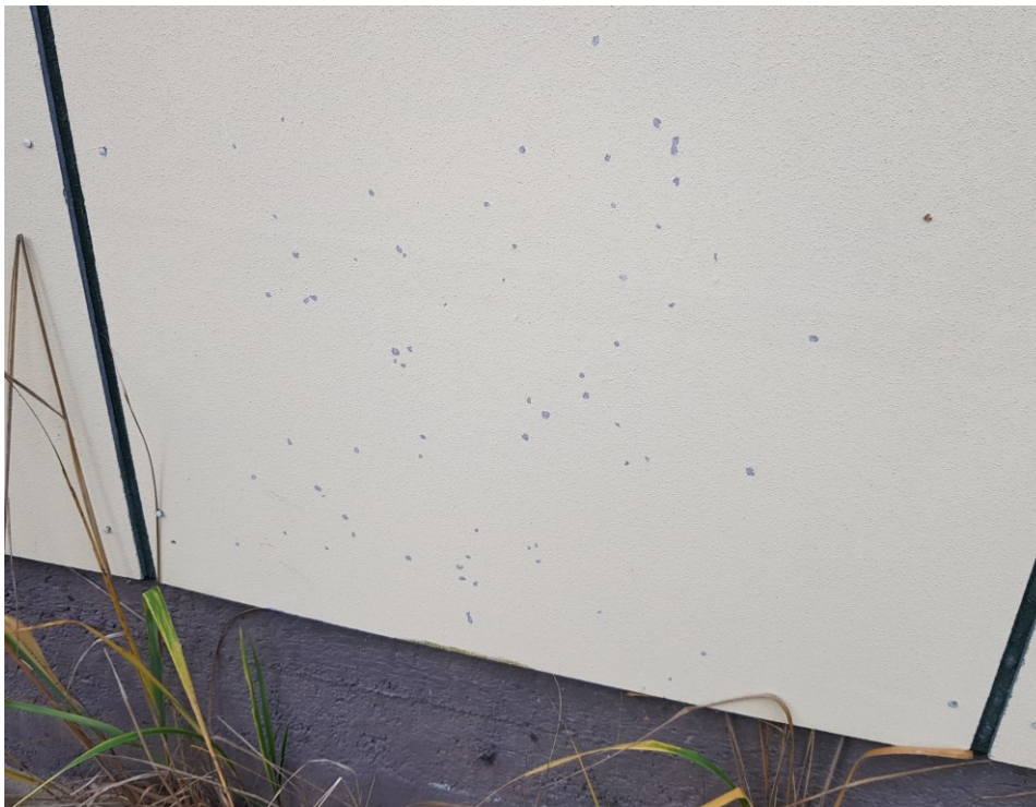
KUVA 20. Kuitusementtilevystä on irronnut maalia
