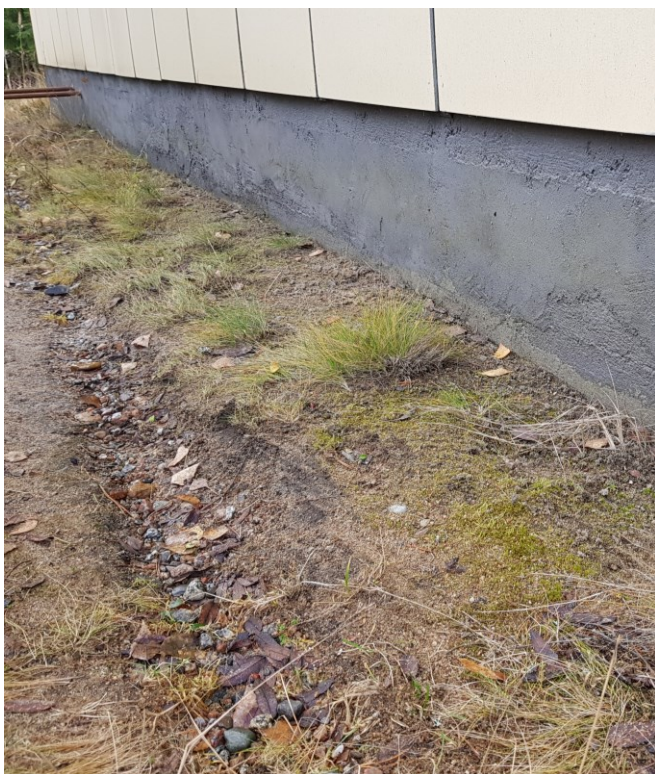
KUVA 9. Talon pohjoispäädessä katolta valuva sadevesi on kuluttanut maata
