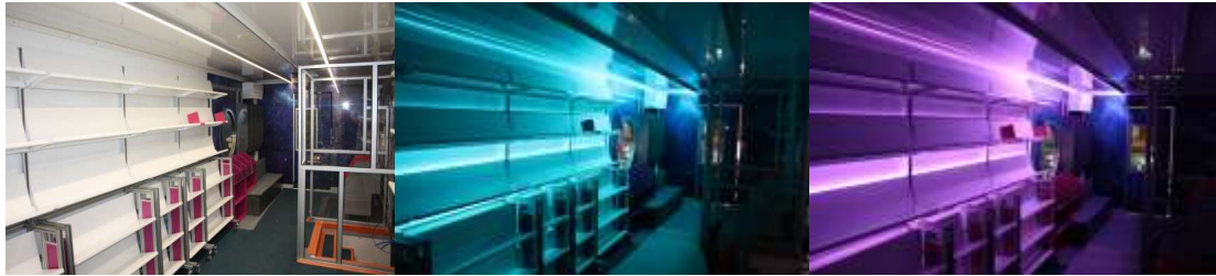
Kuva 13 a, b ja c. Valaistuksella loihditut erilaiset tunnelmat (Conlog Oy 2023.)
