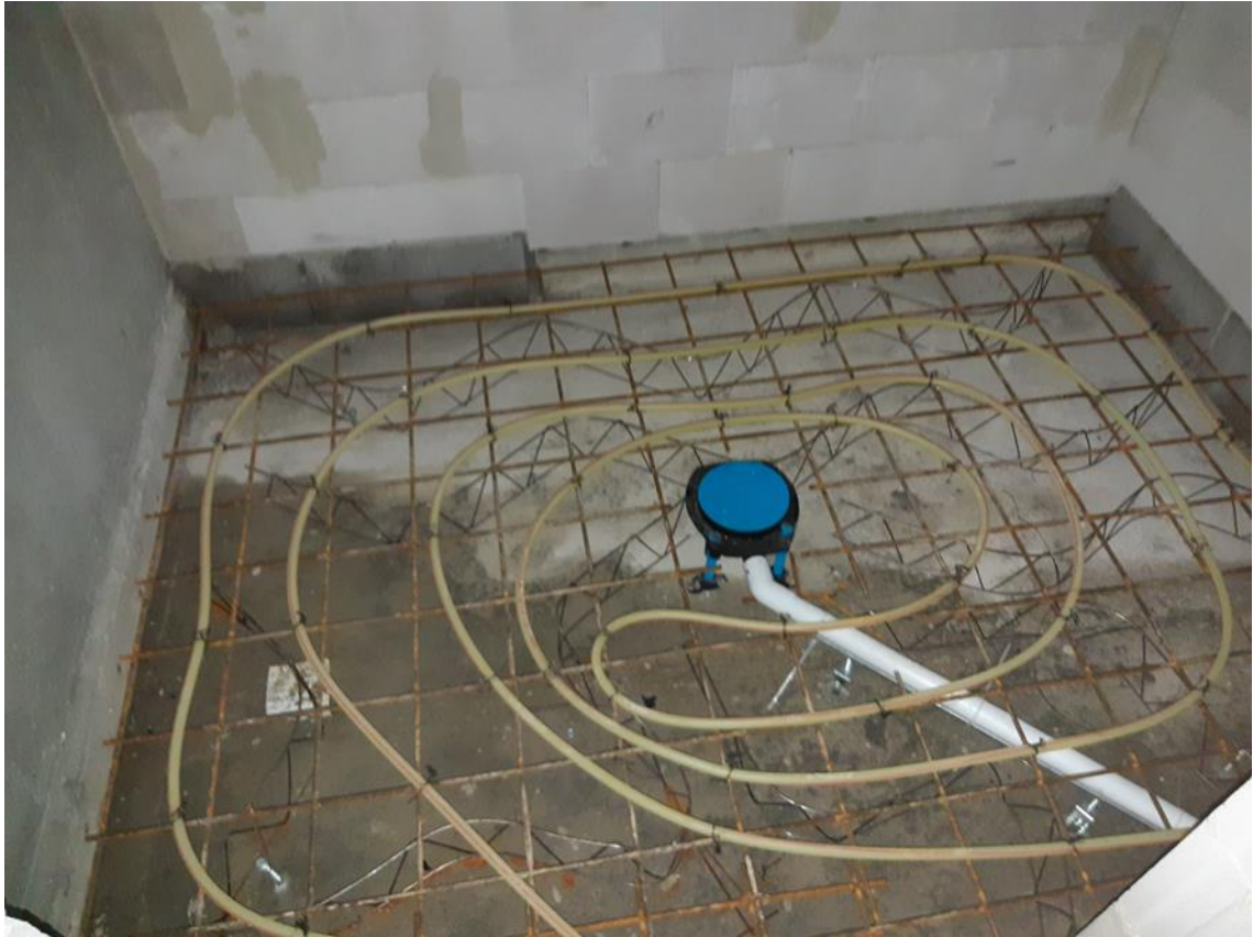
Kuva 6. Lattialämmitysverkoston putkijako referenssikohteen WC-tilassa. (Tatu Ritarin valokuva-albumi)
