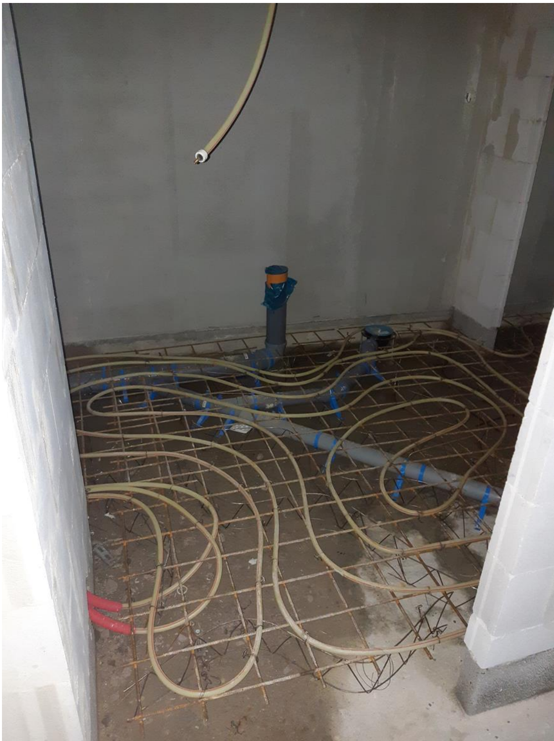
Kuva 5. Lattialämmitysverkoston putkijako referenssikohteen WC-tilassa. (Tatu Ritarin valokuva-albumi)
