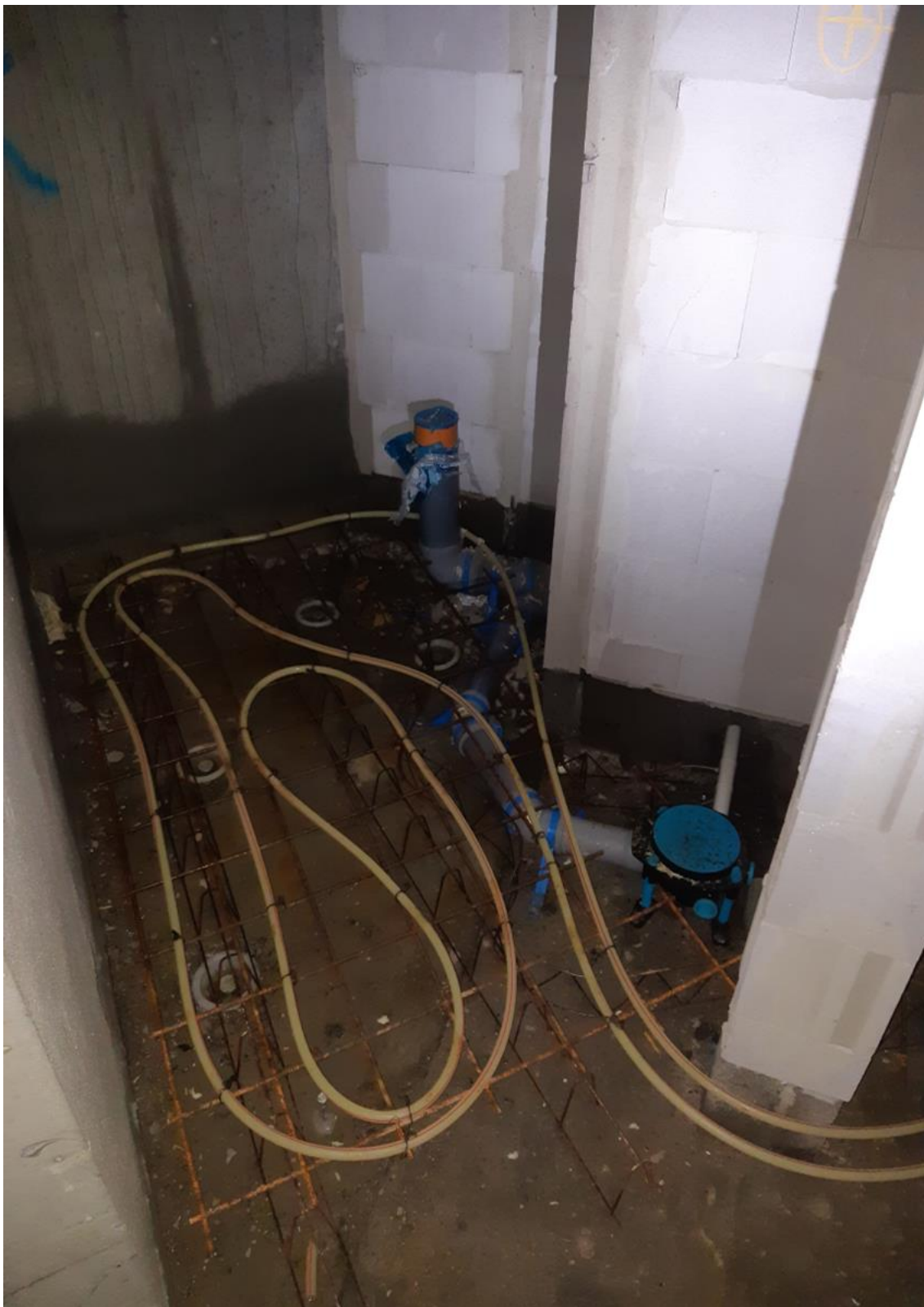
Kuva 2. Lattialämmitysverkoston putkijako referenssikohteen WC-tilassa. (Tatu Ritarin valokuva-albumi)
