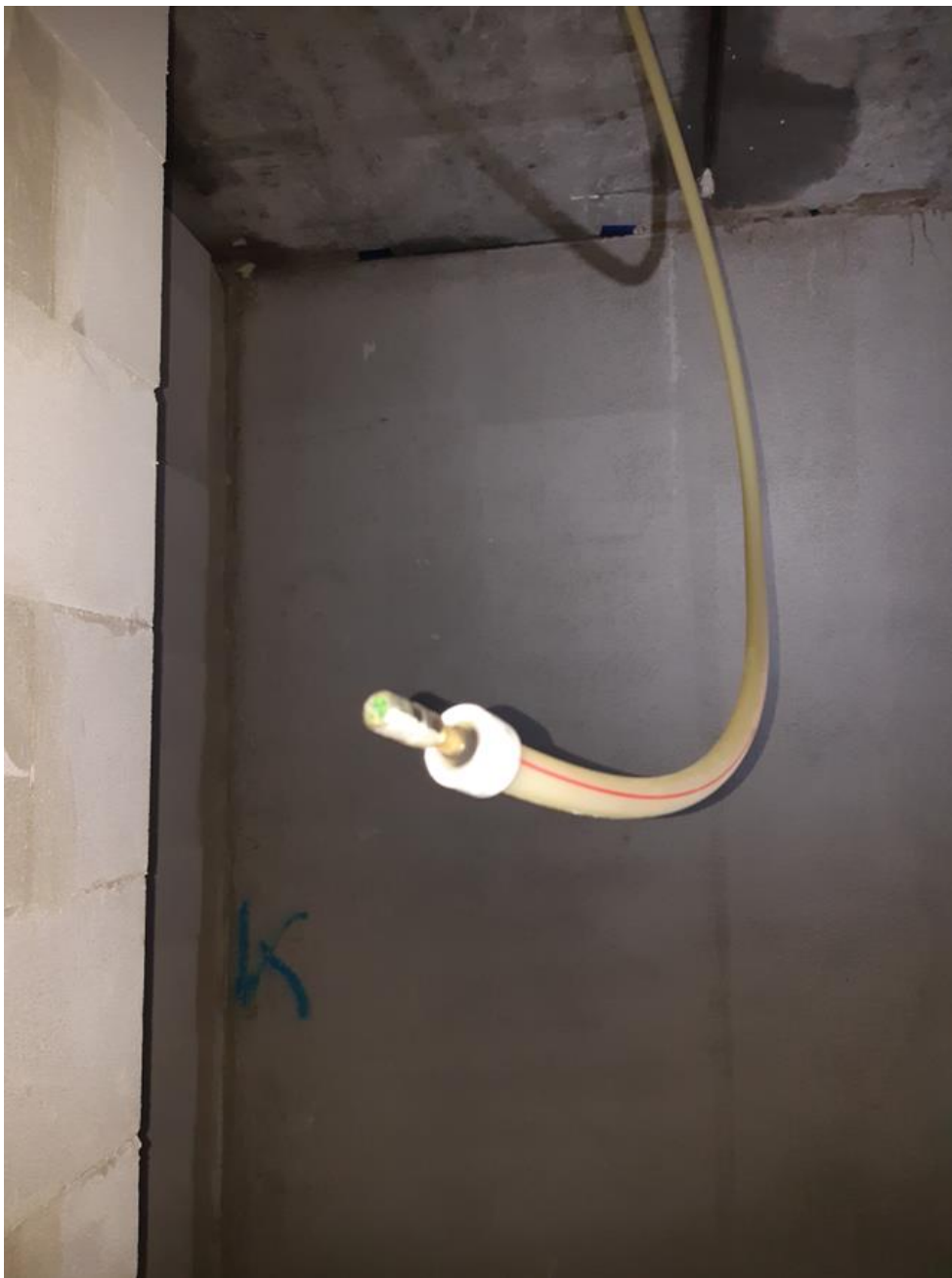
Kuva 10. Lattialämmitysputkiston suojattu putkenpää referenssikohteen WC-tilassa. (Tatu Ritarin valokuva-albumi)
