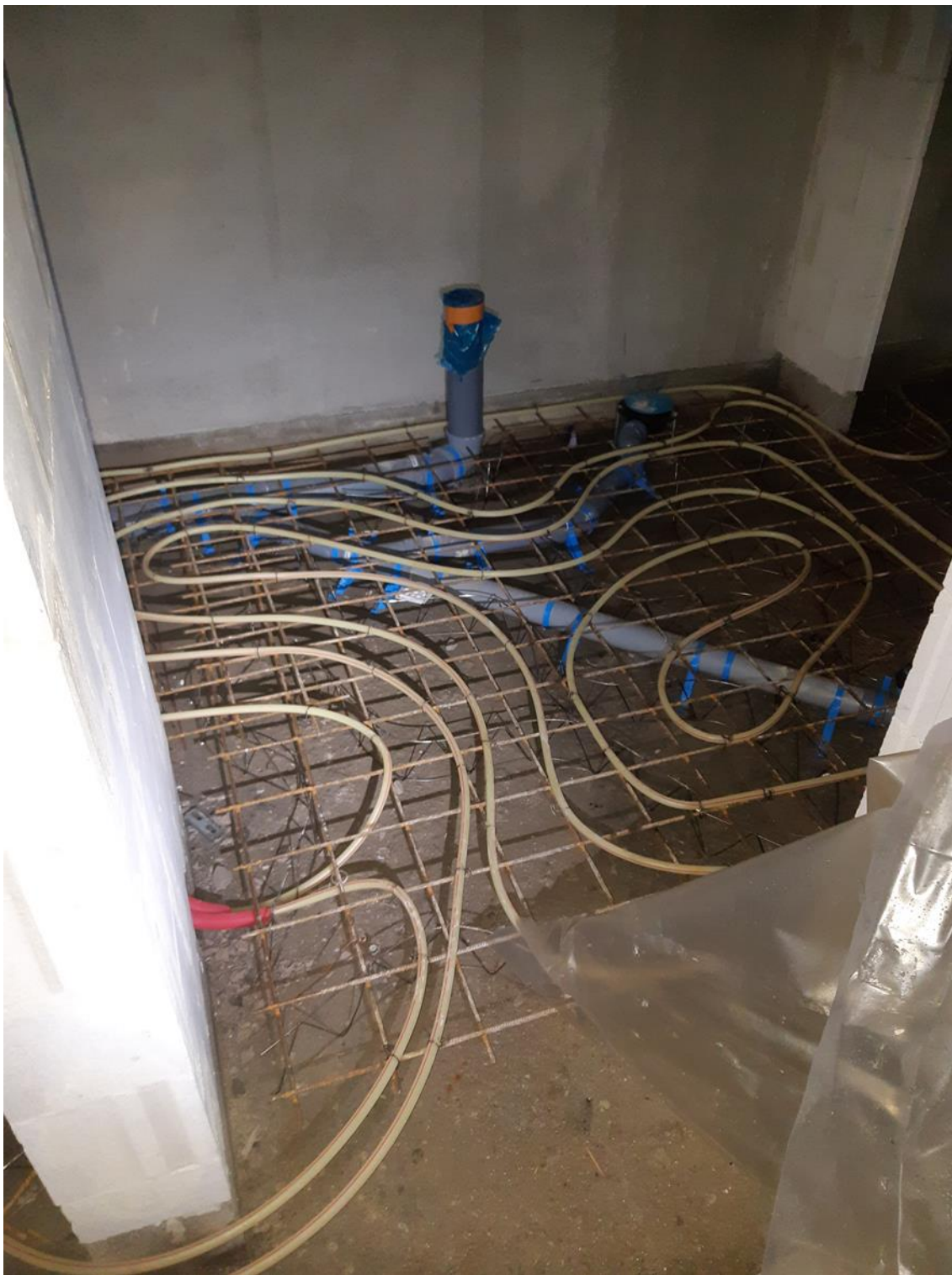
Kuva 3. Lattialämmitysverkoston putkijako referenssikohteen WC-tilassa. (Tatu Ritarin valokuva-albumi)
