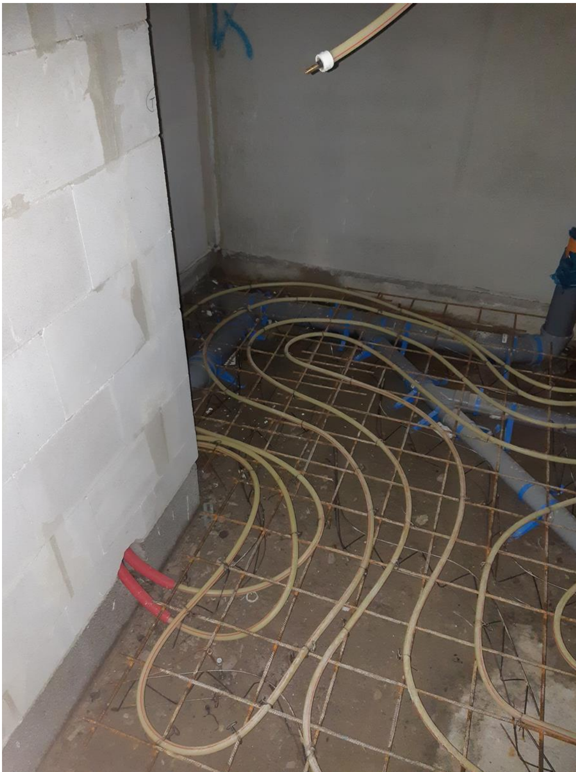
Kuva 4. Lattialämmitysverkoston putkijako referenssikohteen WC-tilassa. (Tatu Ritarin valokuva-albumi)
