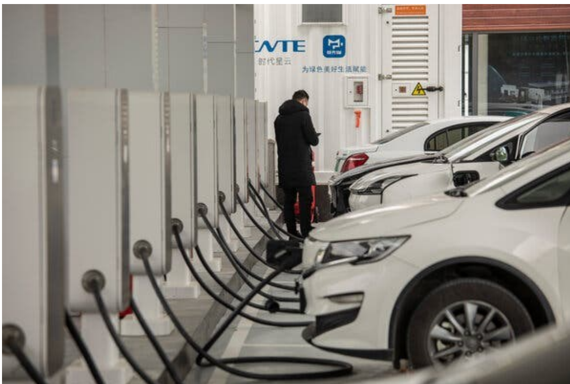
Kuva 13. Sähköautojen latauspiste, jossa etualalla suuri määrä latauslaitteita, ja taka-alalla konttiin rakennettu sähkövarasto. [53]
