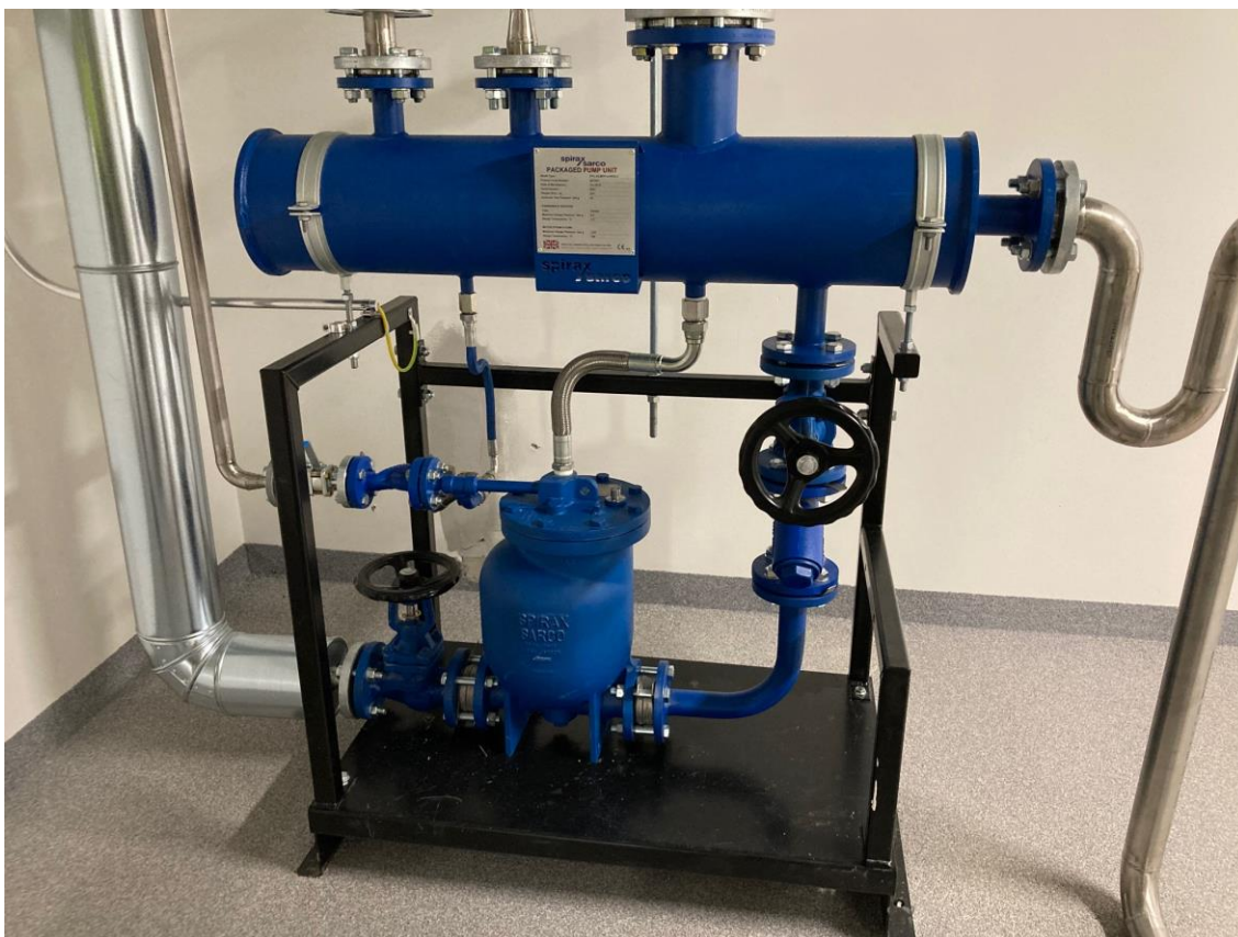
Kuva 24. Toinen Siltasairaalan lauhteenpalautusyksiköistä.
