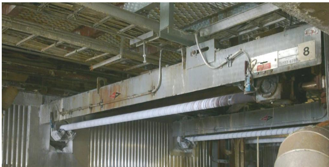
KUVA 12. Soodakattilan höyrynuohoin (Tuononen Jonne,2012).
