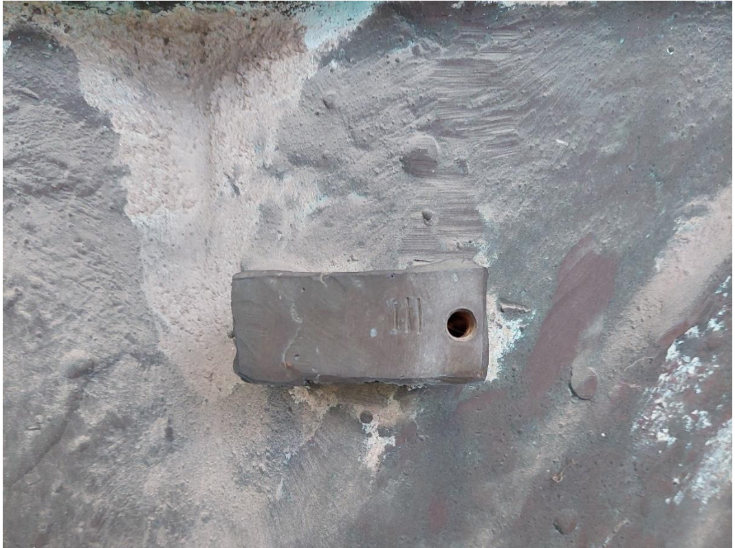
Kuva 13 Kiinnitys uloke III ja havaittavissa kipsikuonaa
