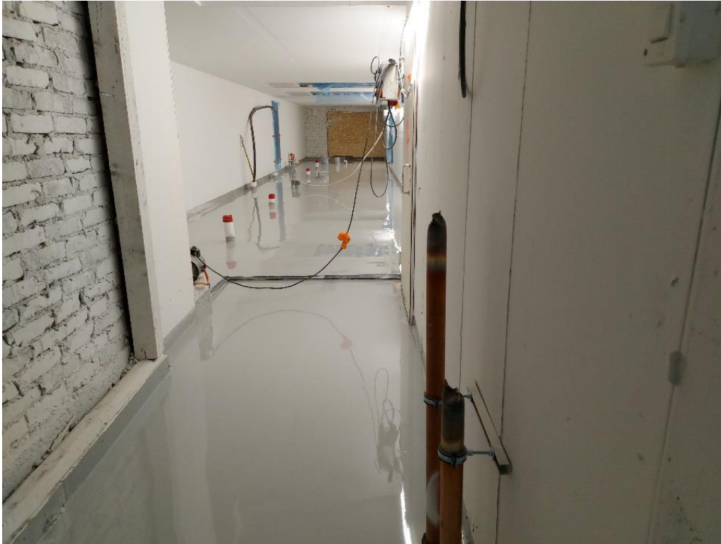
KUVA 18. Rakennustyön osalta valmis ilmanvaihtokonehuone
