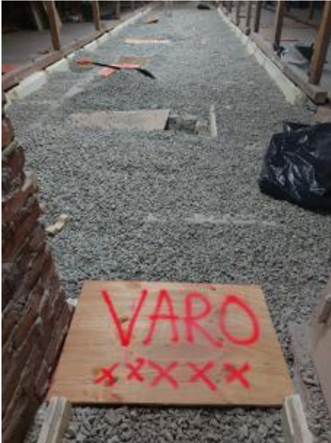
KUVA 12. Läpivientiaukkojen päälle laitettiin selkeillä varoituksilla varustetut askelsuojat
