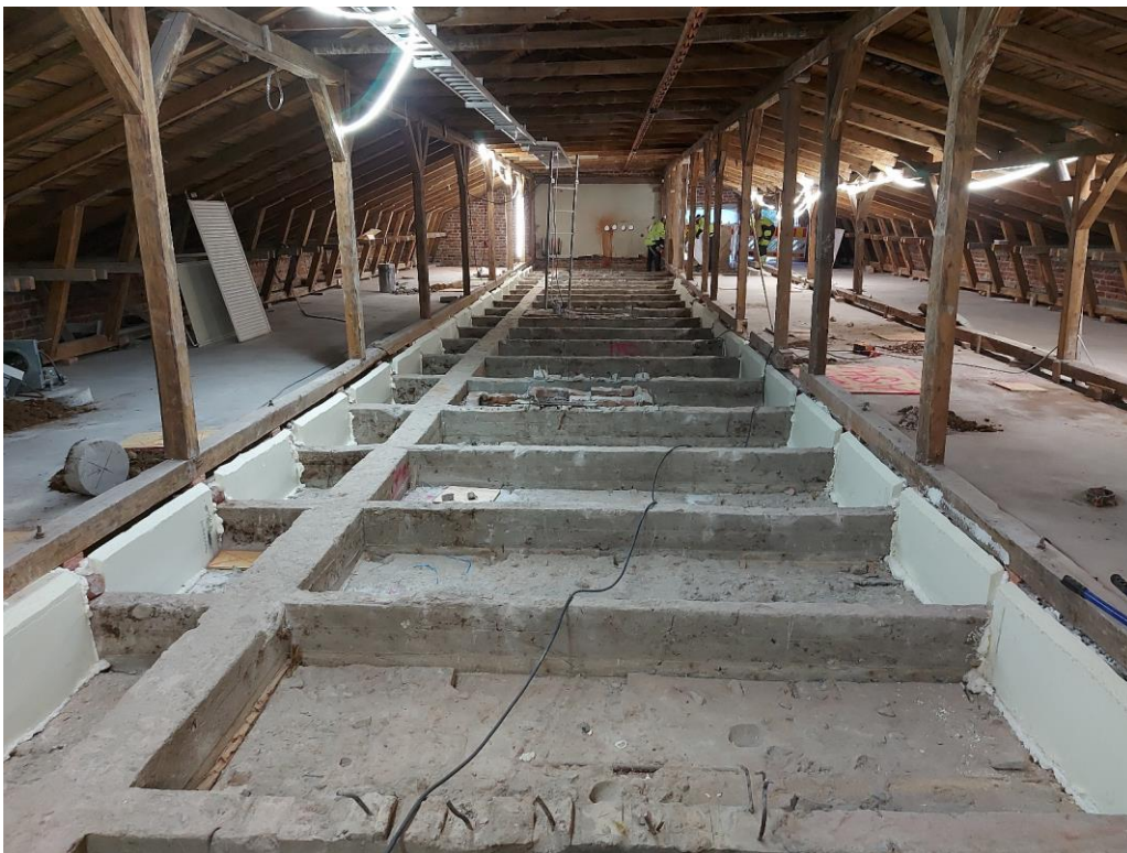
KUVA 9. Konehuone B alkutilanteessa
