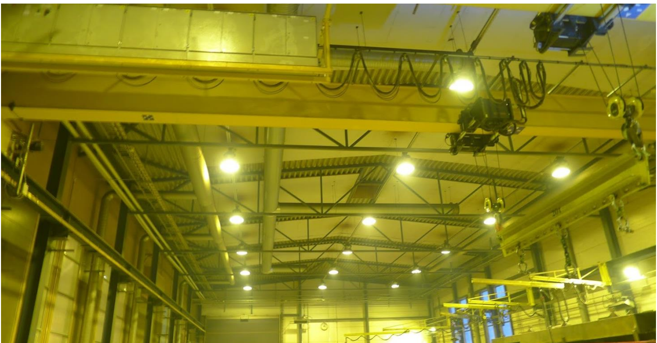
KUVA 7. Varusteluhalli 2. Laajennus. Valaisimien asennuskiskot ovat katossa hallin pitkittäissuunnassa.
