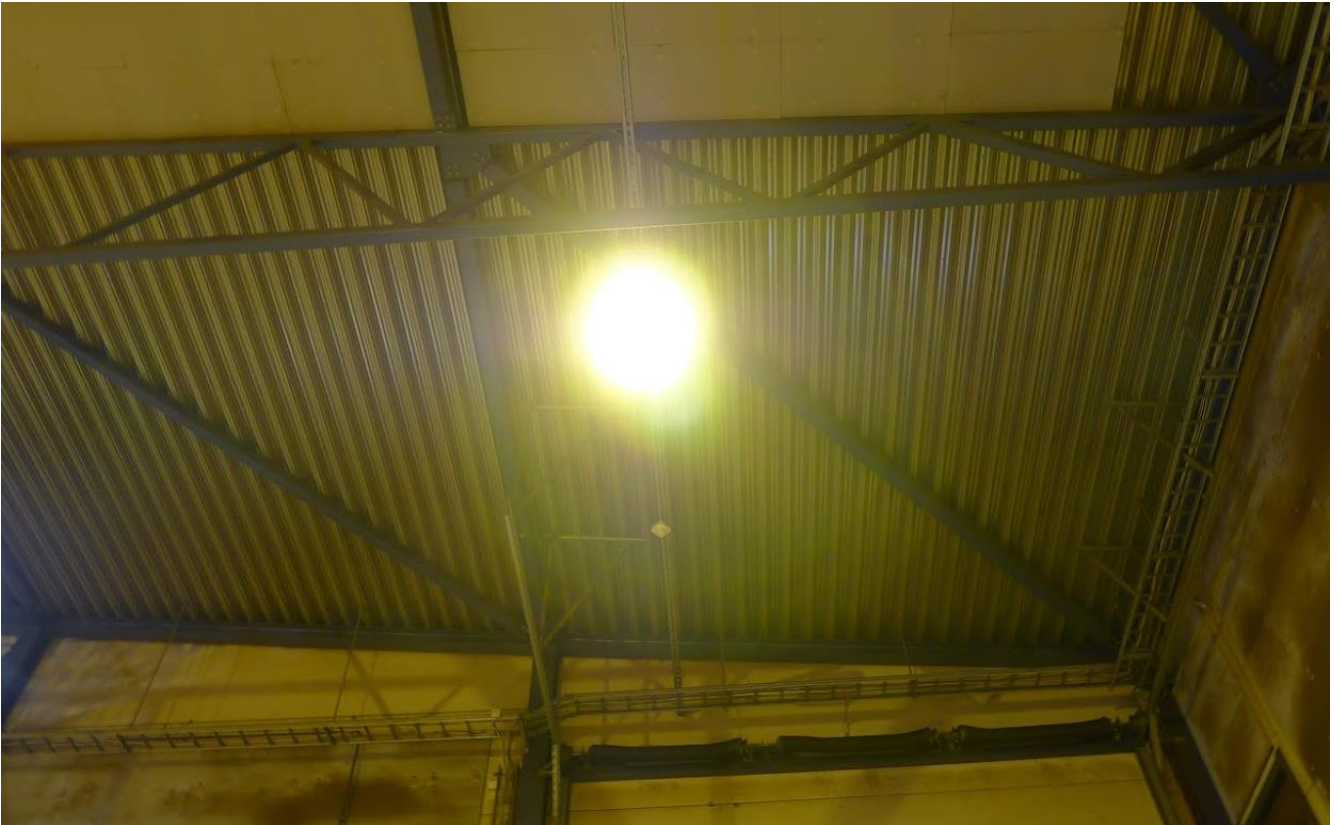
KUVA 5. Valaisinkiskot katossa hallin pitkittäissuunnassa.
