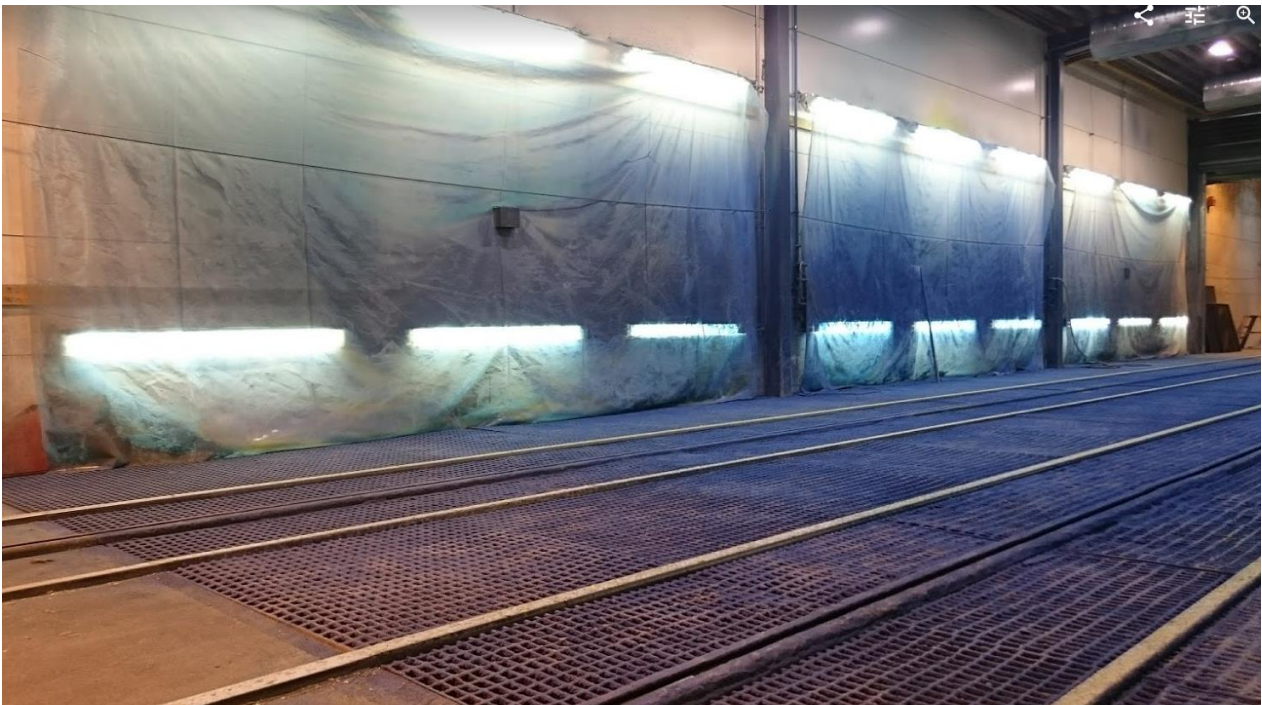
KUVA 9. Maalaamo. Loistevalaisimien valaistusteho vaikuttaa aika vaatimattomalta.
