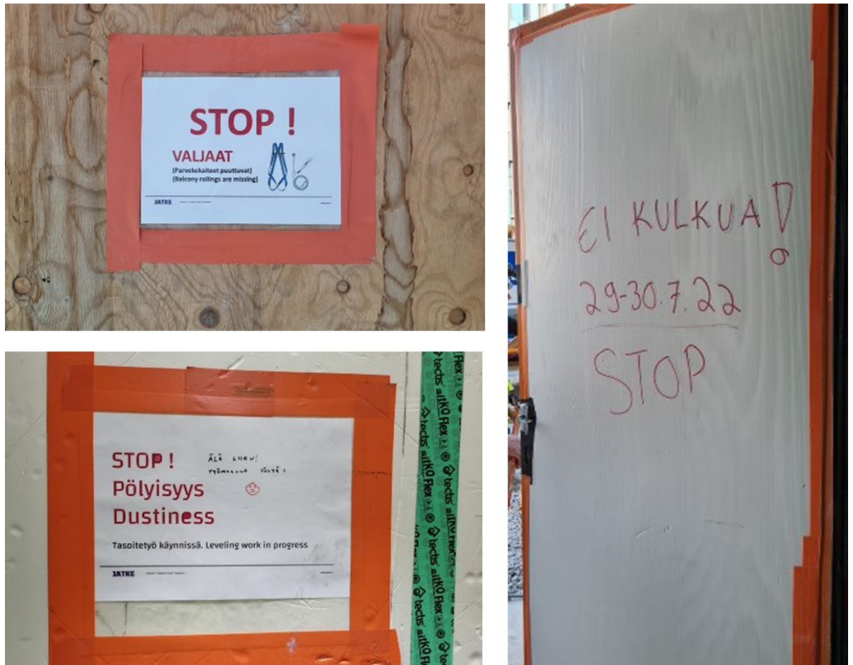
Kuva 6. Väliaikaisia opasteita rakennustyömaalla (Ahola 2022)
