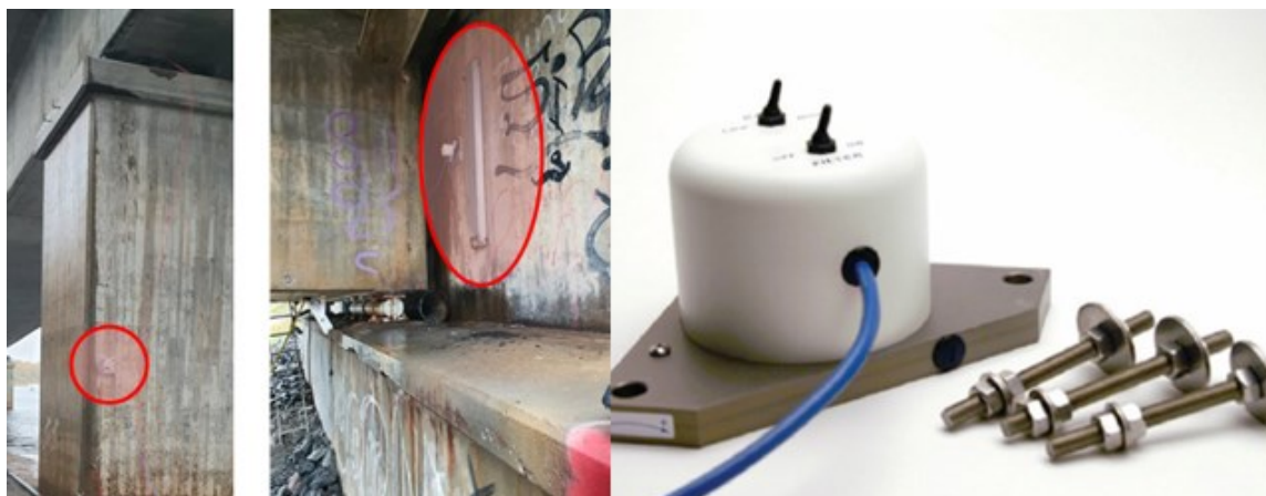
KUVA 41. Seinäkaltevuusmittari tuessa 5 (vasemmalla), tuessa 6 (keskellä) ja mittari oikealla esitettynä. (Kalix Bridge Project 2022, 35)
