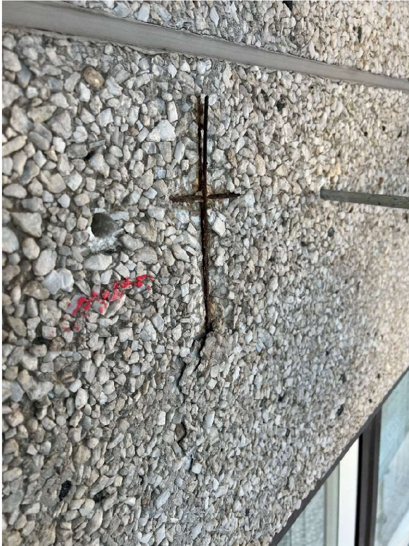
Kuva 4. Teräskorroosion aiheuttama vaurio (Collander, 2023)
