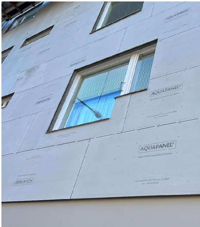
Kuva 13. Levysaumot eivät kohtaa ikkuna-aukon reunojen kanssa (Collander, 2022)
