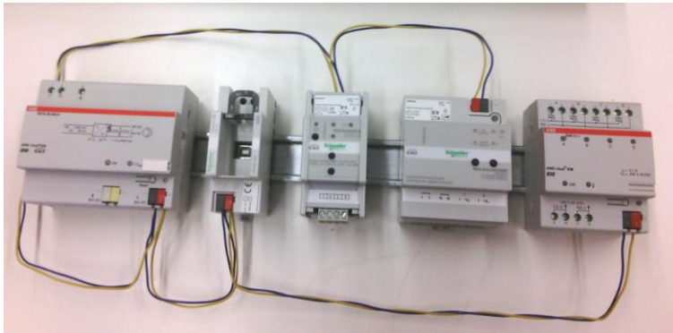
Kuva 13. Opetusympäristön laitteet, kokoamisvaihe, KNX-kaapelointi
