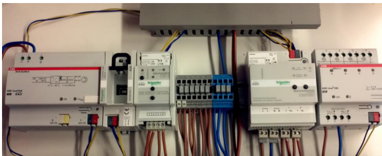
Kuva 14. Opetusympäristön laitteet, sähkönsyöttö
