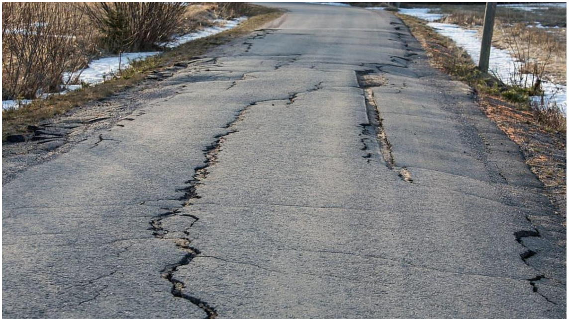
Kuva 1. Roudan aiheuttaman maaperän elämisen tuottamat vauriot
