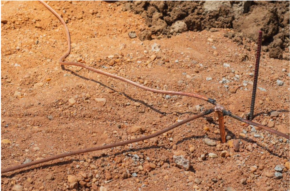
Kuva 3. Maadoitussauva, johon yhdistetty vaakamaadoituselektrodeja. (Lähde: https://www.elek.com/au , luettu 31.3.2023)
