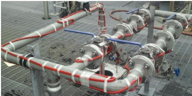
Kuva 14. Saattolämmitys, sähkö (Gis Elektrik 2023).
