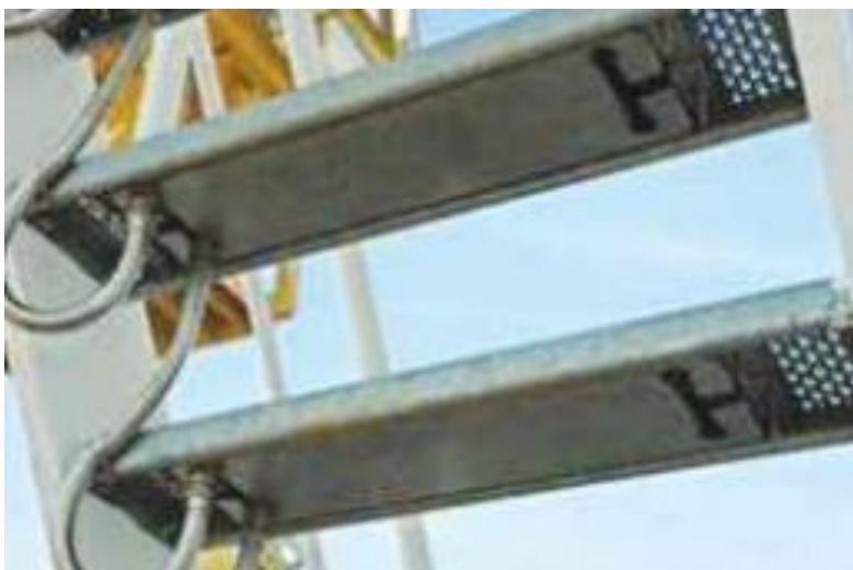
Kuva 16. Portaikkojen lämmitys (Thermon n.d., 3).
