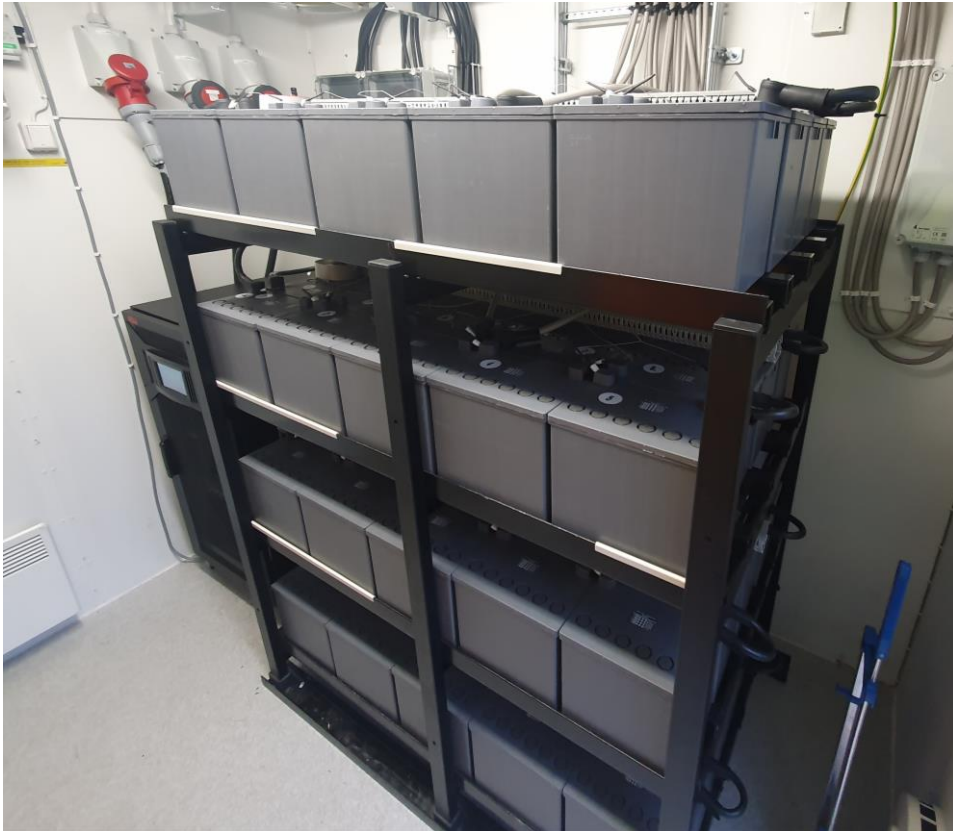
KUVA 24. Uusi UPS-laite ja akusto laitetilassa
