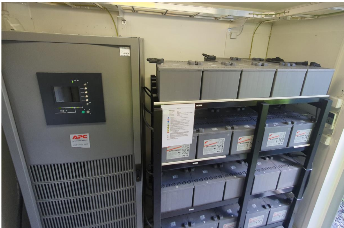
KUVA 22. Vanha UPS-laitteisto laitetilassa
