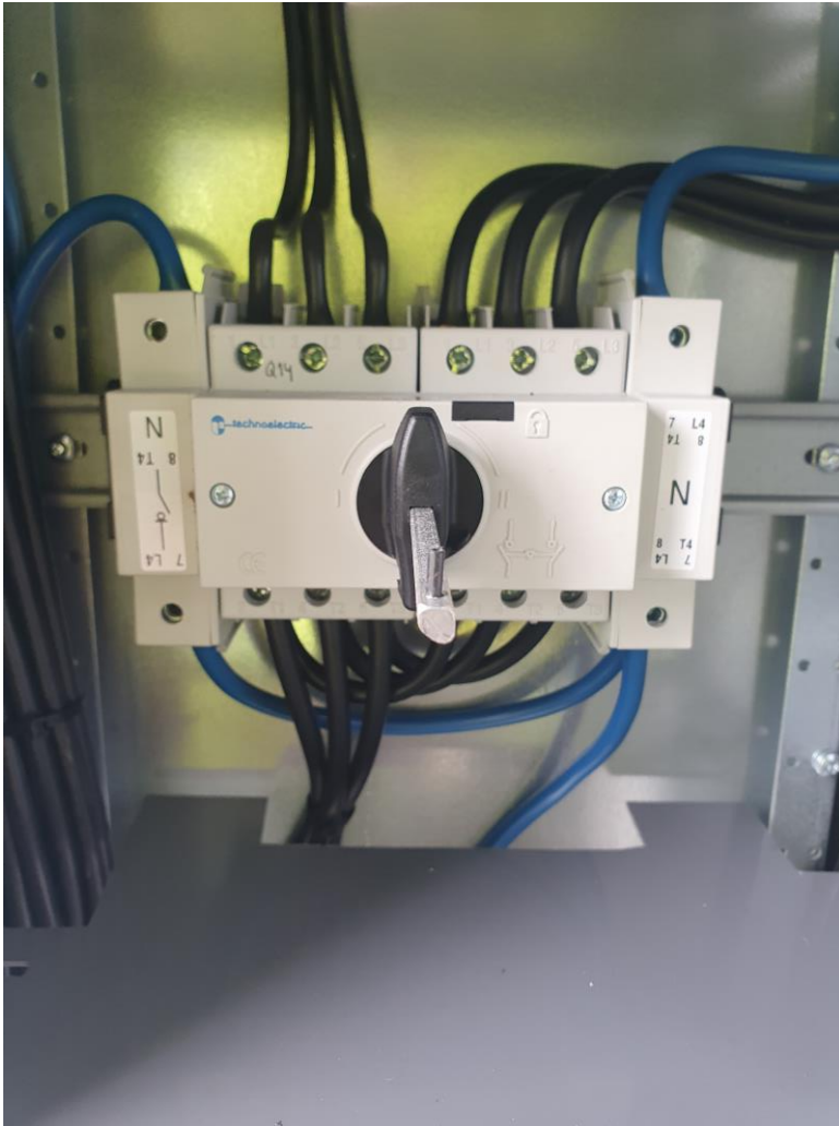
KUVA 5. Juontokytkin Q14 asetettuna 0-asentoon kuvattuna keskuksen sisältä
