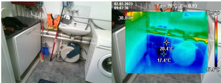
KUVA 15. Kodinhuoltohuone / tekninen tila (lämmönvaihdin kaukolämpö)
