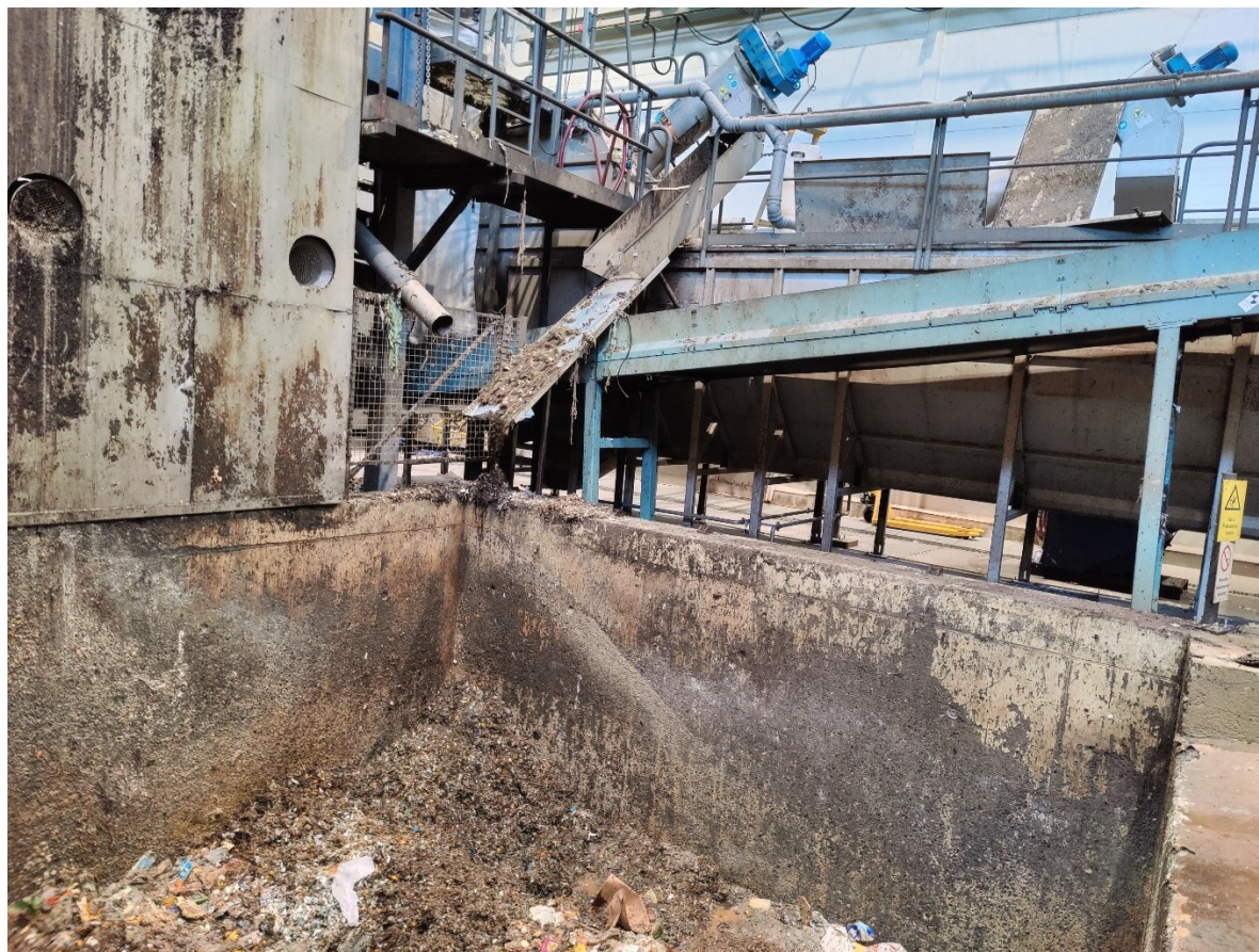
Kuva 37. Välppähyllyn poistokourua jatkettiin siten, että hylky palautui biojätessiin (Harri Manu 2022, CC BY-SA).
