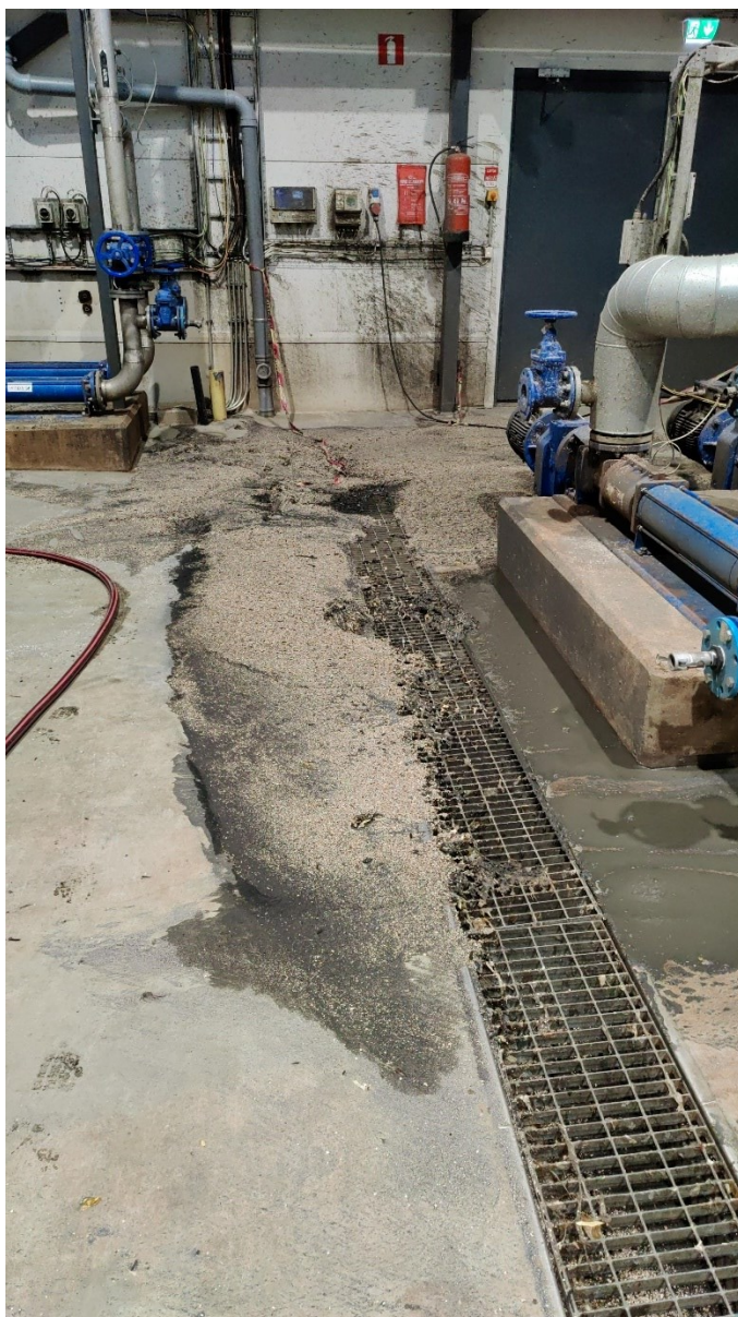
Kuva 38. Putkitukos avattuna lattialle Kuopion biokaasulaitoksella. Vaaleanruskea sakka on kananmunien kuorta (Harri Manu 2022, CC BY-SA).
