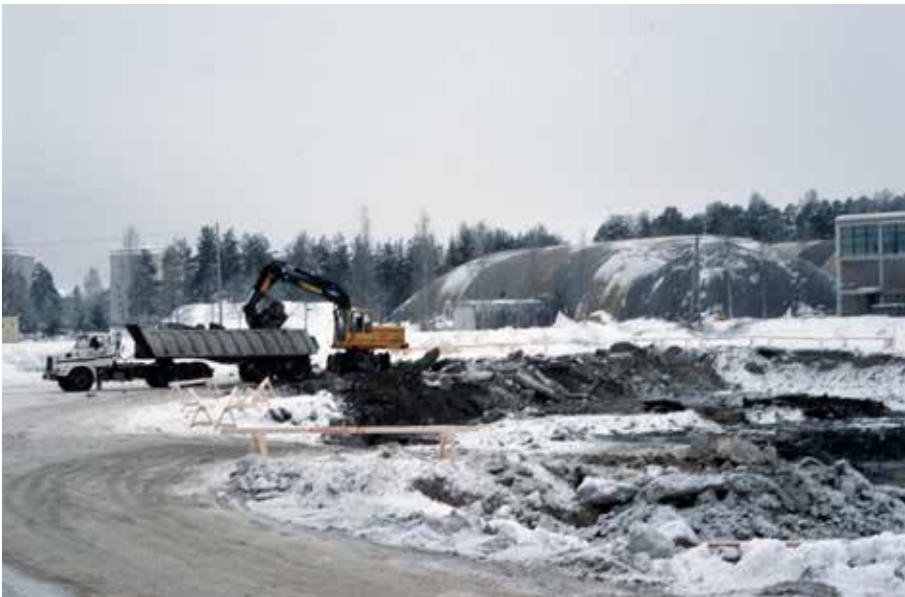
Kuva 11. Hippos-hallin ja harjoitusjäähallin varsinainen rakennusvaihe alkoi helmikuussa 1991. Kuvassa rakennusmonttu, jota on vasta alettu kaivaa. Takana oikealla Monitoimitalon nurkka ja kuplahalli, jolla paikattiin liikuntapaikkapulaa. Kuvaaja: Taito Mörk, 1991. Kuva: Keski-suomen museo (K2167/1210).
