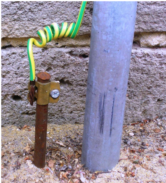
Kuva 6 Maahan johtavaan tankoon liitetty maadoitusjohto.
