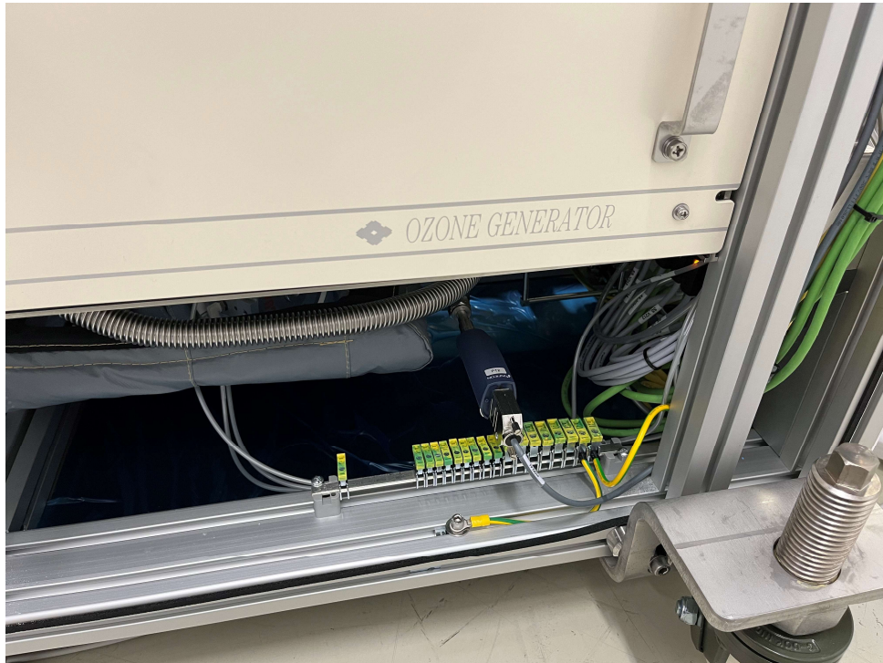
Kuva 14 Laitteen alaosassa oleva maadoitusrima 1
