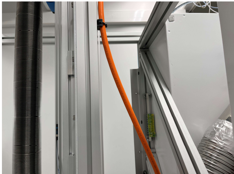
Kuva 15 Laitteen yläosassa oleva maadoitusrima.
